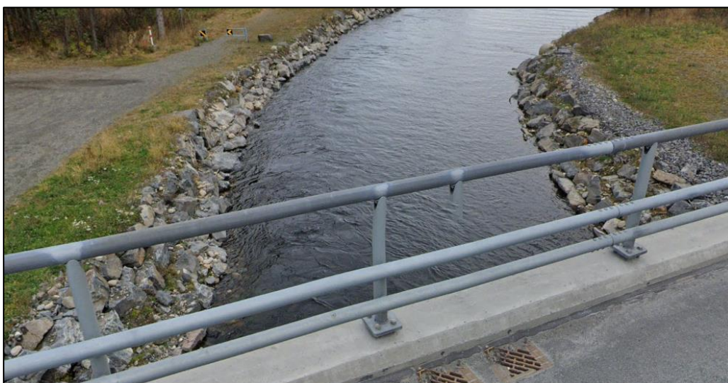
Figur 28: Eksisterende erosjonssikring nedstrøms dagens bru E6 over Rinda (Bilde fra Google maps)
