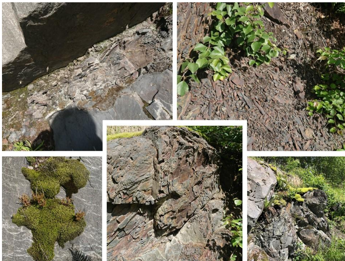
Figur 17: Store kontraster på bergmassekvalitet og forvitningsgrad i liten skjæring sør for Vingrom. Lokalitet på østsiden av dagens E6, på motsatt side i forhold til skjæringen vist på
