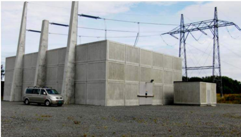
KOSTER: En muffestasjon på Hamnset i Møre og Romsdal. Anlegget fører strøm ut til Ormen Lange-anlegget og noe lifnende som denne stasjonen må bygges i Hardanger hvis det blir sjøkabel. Foto: Statnett / Scanpix
