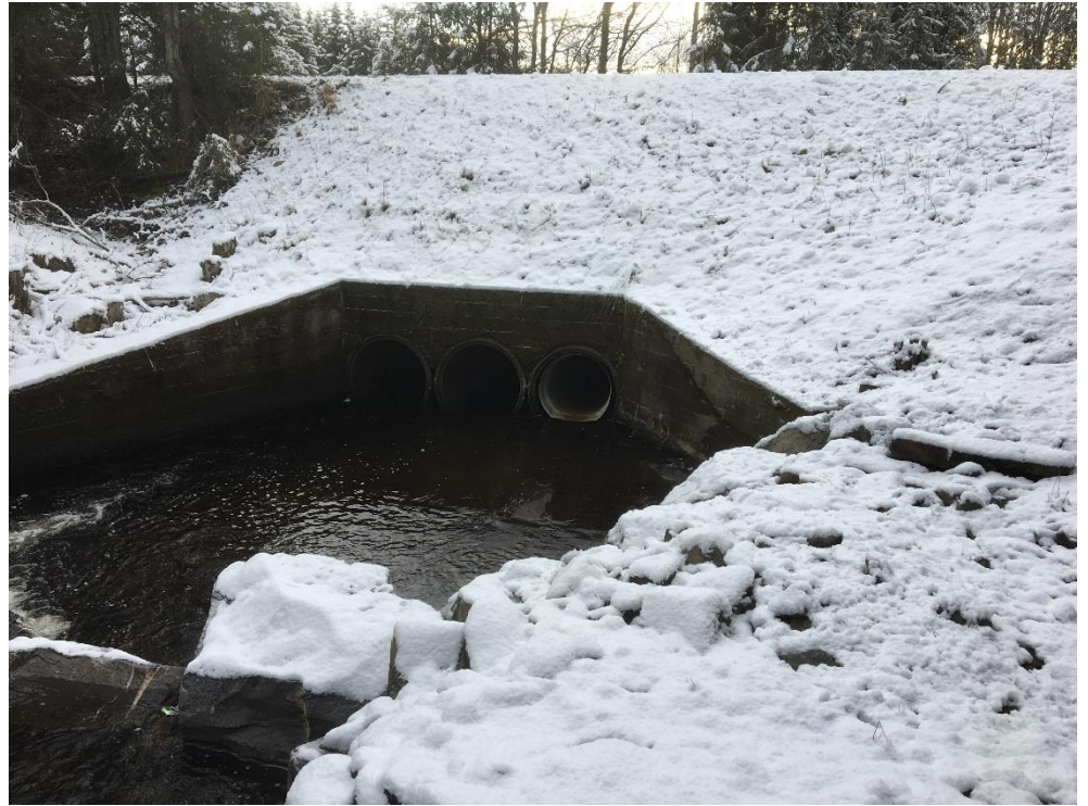
Figur 3. Kritisk punkt i Skurvbrua under Nordsetervegen.
