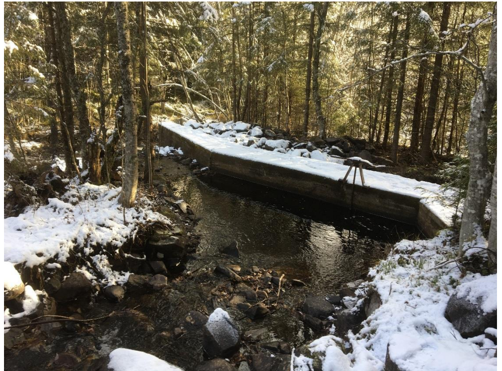
Figur 4. Kritisk punkt ved Skryftgangen hvor vann fra nabovassdraget kan tilføre vann til Skurva.
