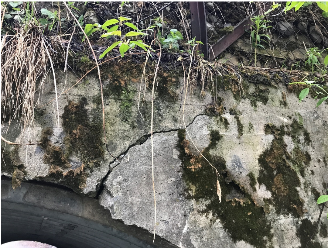
Bilde 24 stor sprekk over gangkulvert, samt begroing og misfarging
