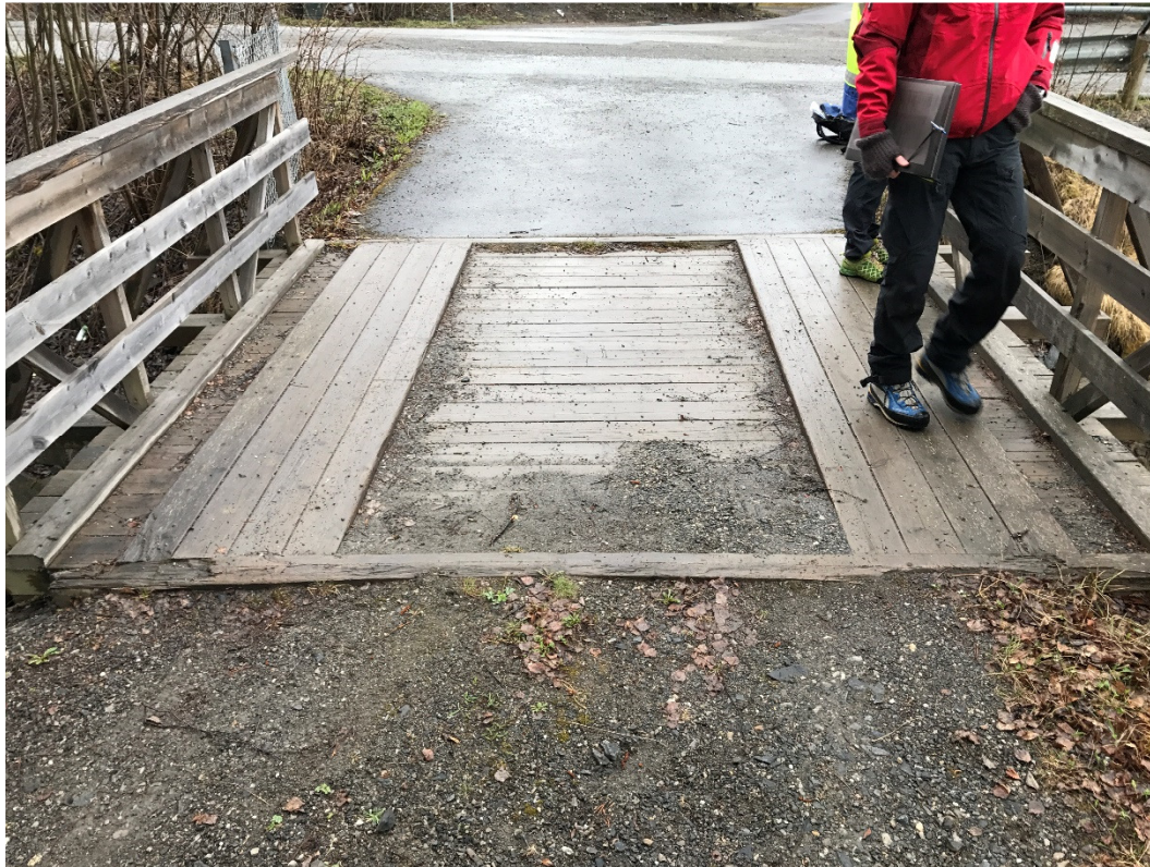
Bilde 4 slitasje og mulig råte i treverk
