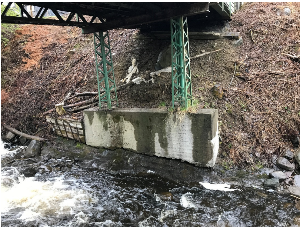
Bilde 18 fundament har ikke ordentlig kontakt med fjell
