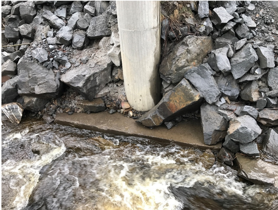
Bilde 2 små avskallinger på fundament
