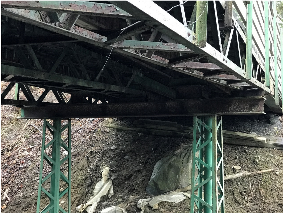
Bilde 19 rust på bjelke, samt noe tilfeldig utførelse av stålforbindelser
