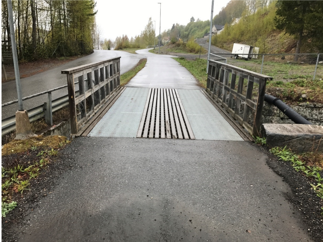
Bilde 37 noe oppflising på enkelte bord i brudekket, samt ødelagt netting noen steder på rekkverk
