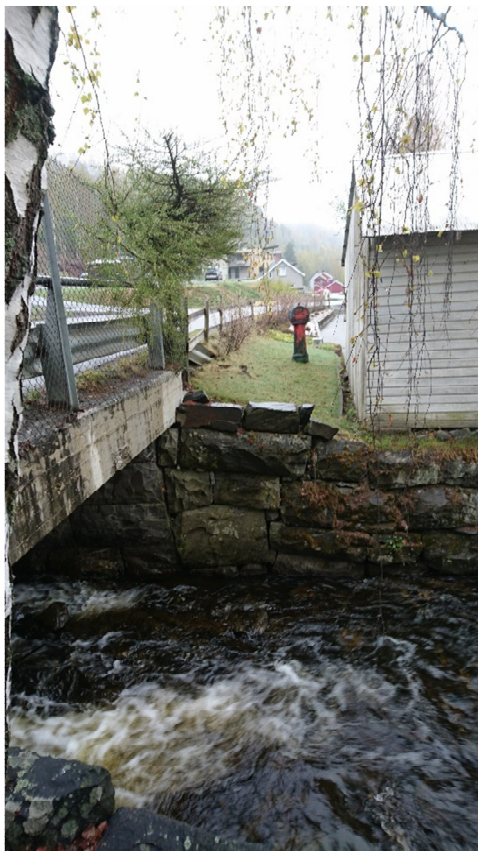
Bilde 41 avskalling i betong med synlig armering
