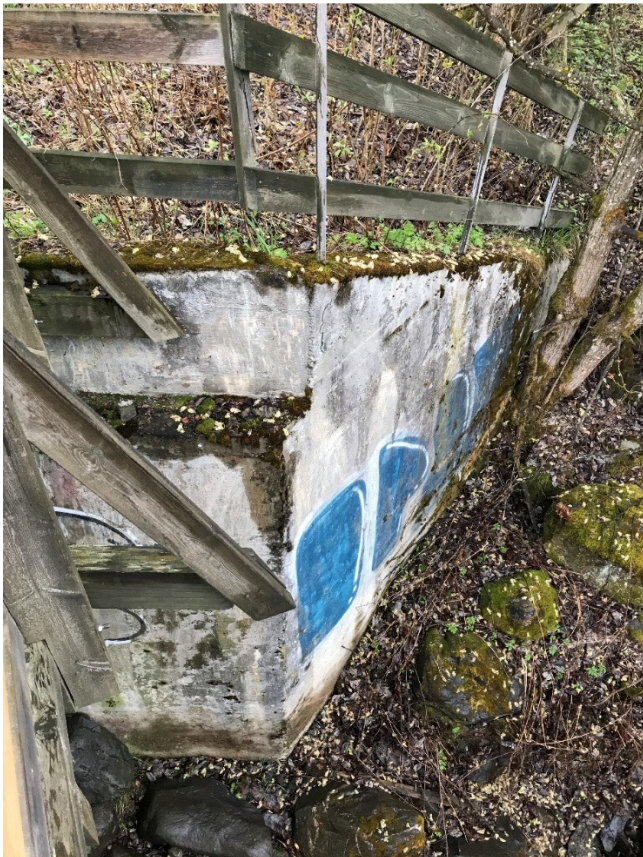
Bilde 33 begrodd betong med noe misfarging og litt ru overflate
