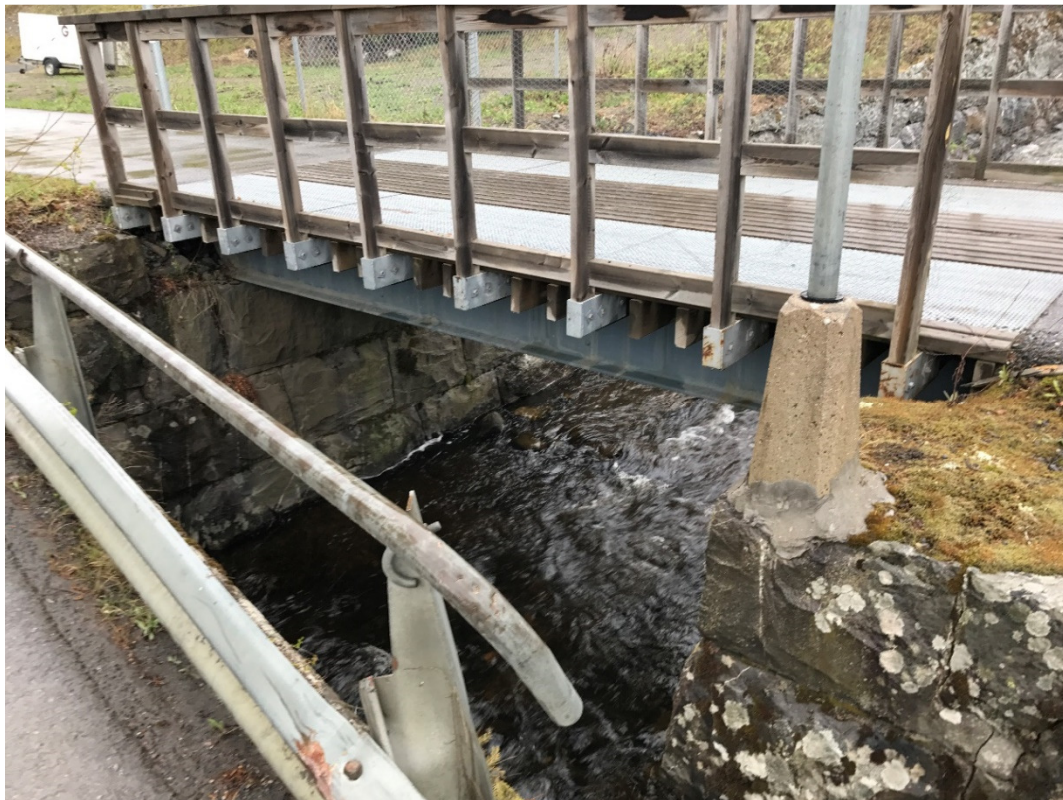
Bilde 38 noe korrosjon på enkelte rekkverksfester
