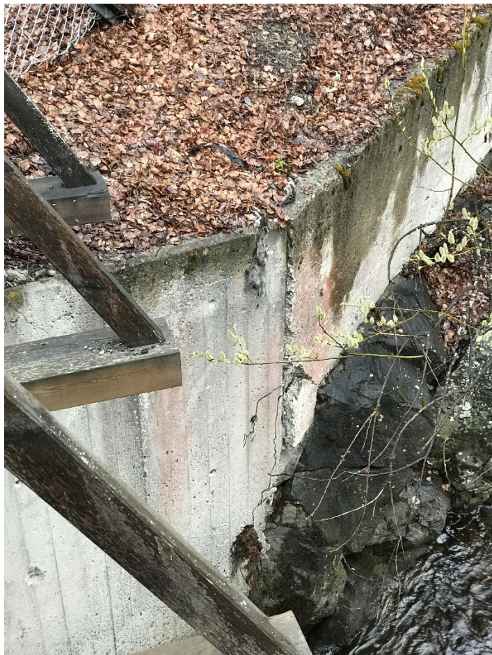
Bilde 6 avskalling og grov overflate
