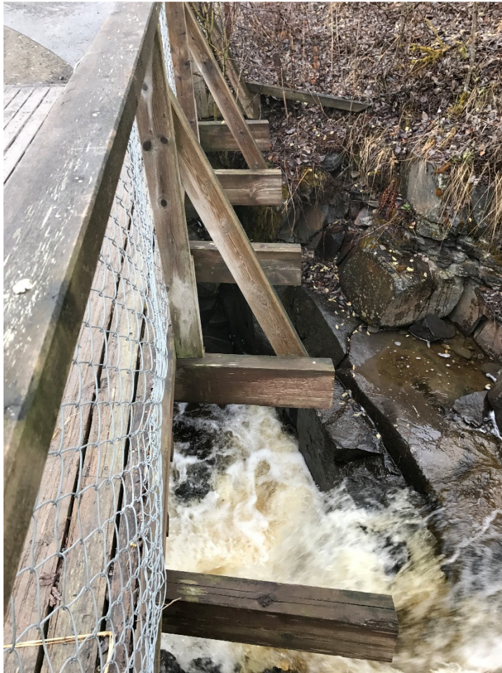
Bilde 8 oppflising og sprekker i treverk
