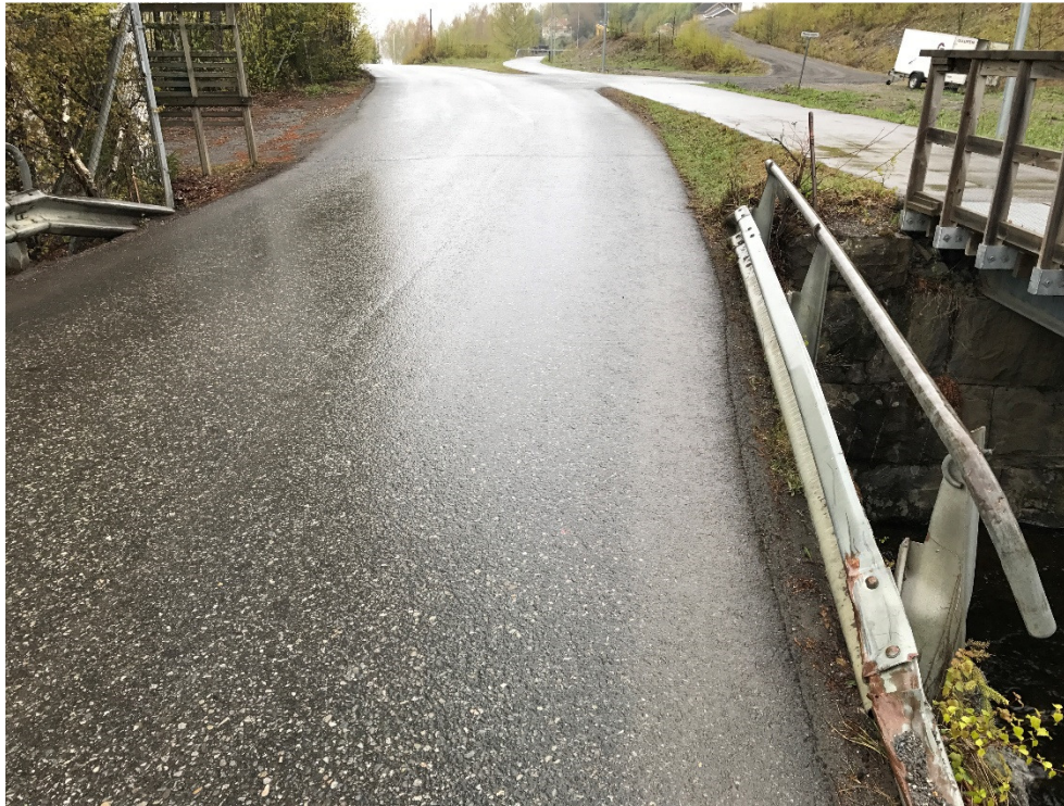
Bilde 40 skade på autovern
