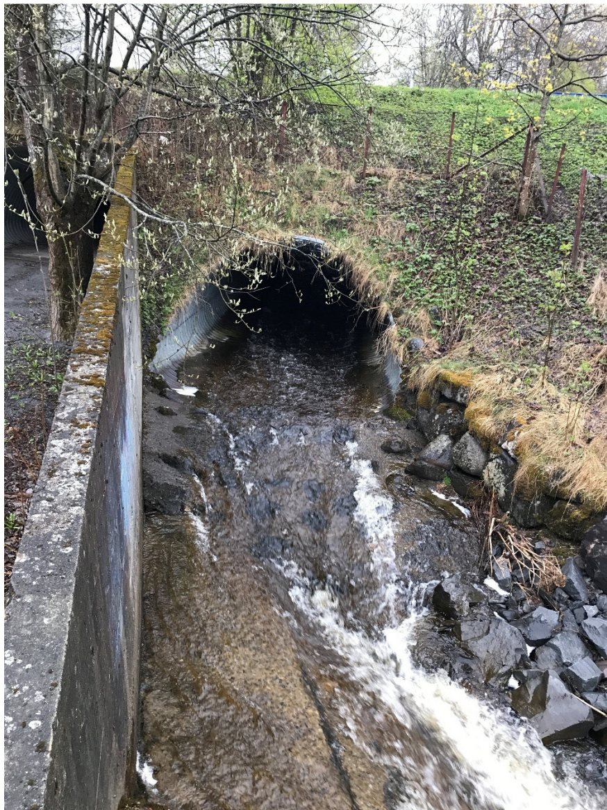
Bilde 25 noe synlig rust i bunnen av stålrør
