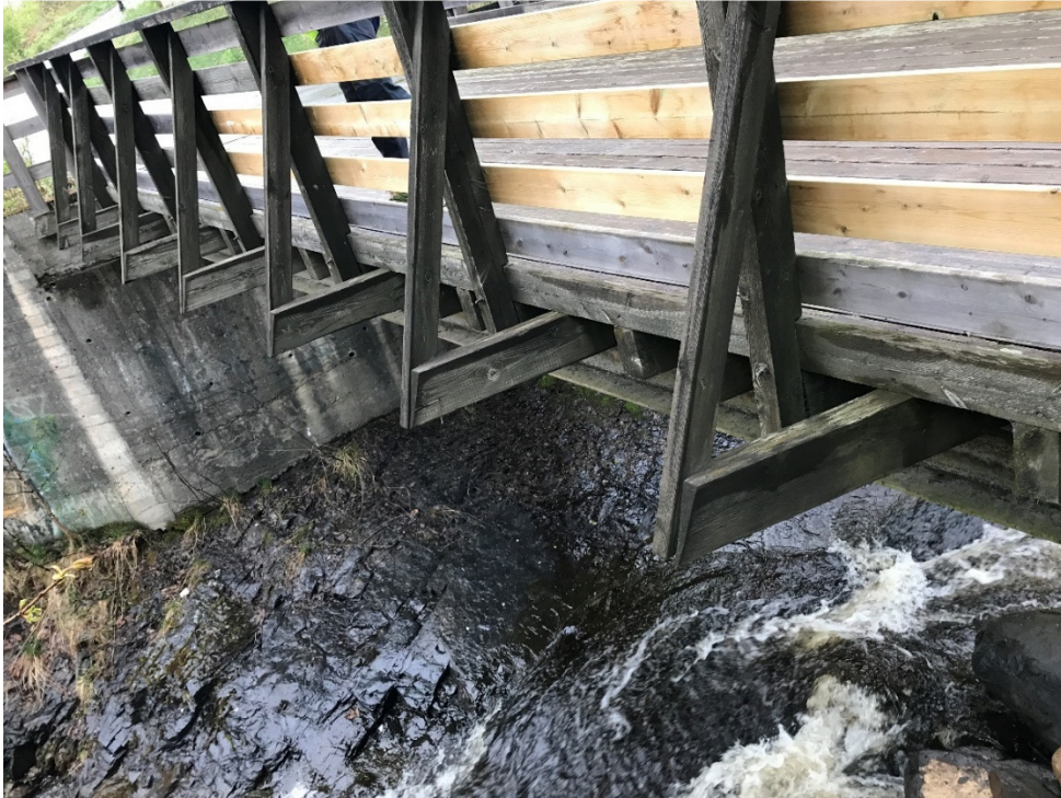
Bilde 32 korroderte stålbjelke, utskiftede bord i rekkverk
