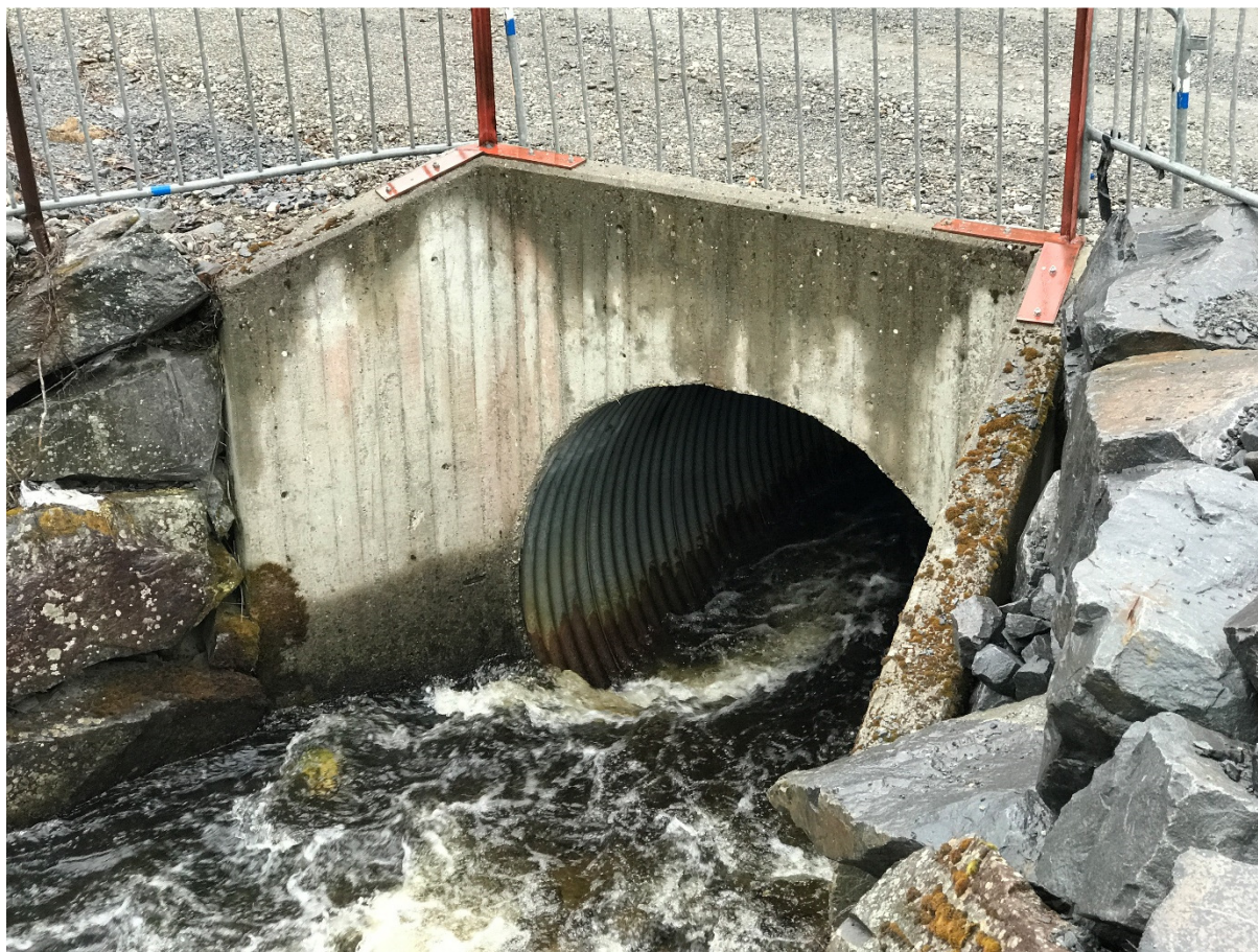
Bilde 12 begroing på betong og korrosjon i stålør
