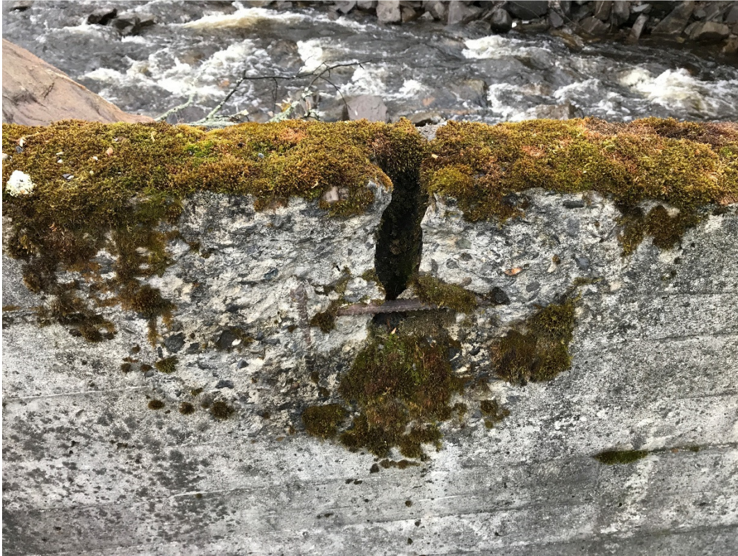
Bilde 23 eksempel på avskalling med synlig armering, samt mye begroing
