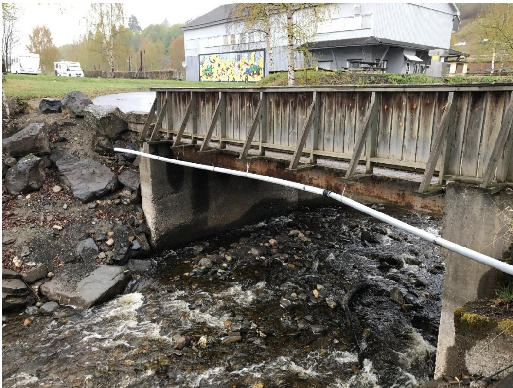
Bilde 46 korrodert stålbejelke, samt delvis utrase masser bak brokar
