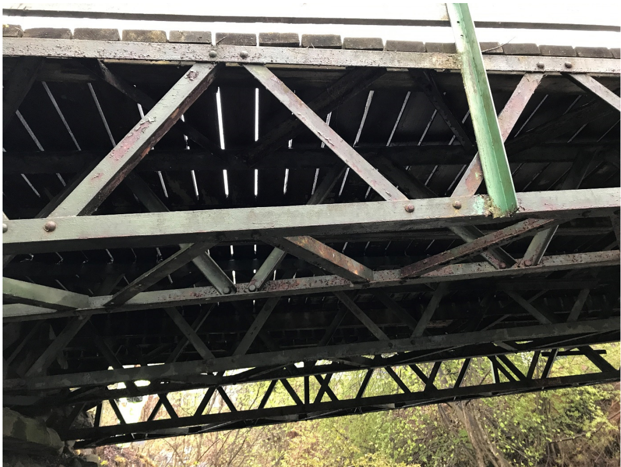
Bilde 16 korrosjon på fagverksbjelker
