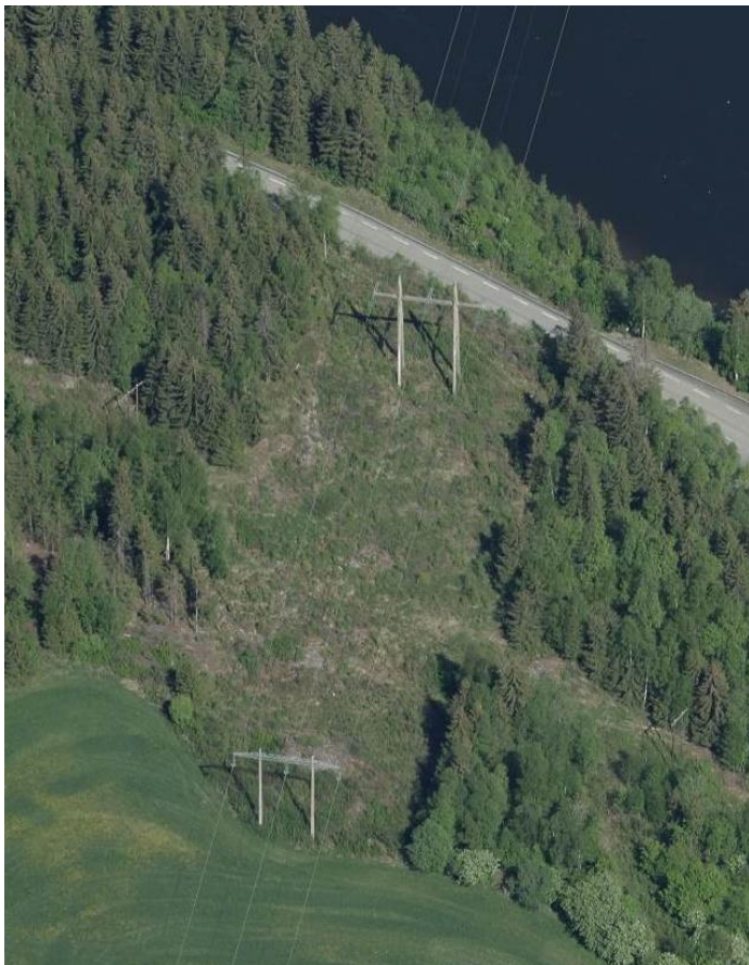
Figur 5-76 Betongmaster på vestsiden av Lågen, i trasé for KDP-alternativet
