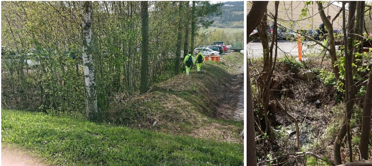
Figur 4.87 (Pkt. F15) Grøft mellom Industrigata 60 og 62. Begge bilder er tatt nedover mot jernbanen (nordsiden av Industrigata 60 skimtes i bakgrunnen). Bildet til høyre viser at vannet står i grøfta og at den og inntaket til OV-ledningen videre (i enden av grøfta) er delvis gjenfylt med kvist etc. Herifra er det udokumentert forløp, antatt over parkeringsplass (som ses i bakgrunnen) og videre ned gjennom ravine/bekkedal ned mot jernbanekulvert.
