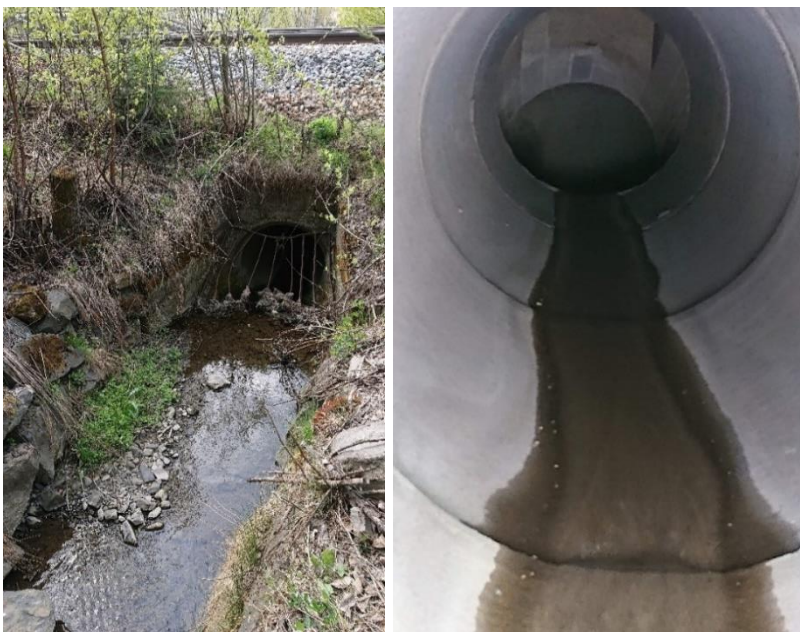
Figur 4.79 (Pkt. F9) Venstre bildene er tatt ned mot inntaket til kulvert/bekkelukking gjennom jernbanen. Bildet til høyre er tatt fra utløpet av kulverten og innover. Vertikalendring (dropp) like innenfor inntaket kan sees.
