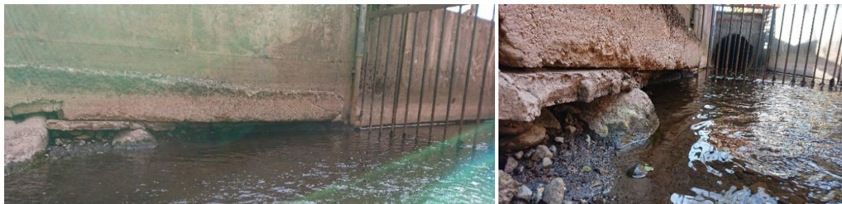
Figur 4.66 (Pkt. N2) Inntak bekkelukking ved Lundebekken studenthjem, sett fra oppstrøms. Venstre vange er undergravd.
