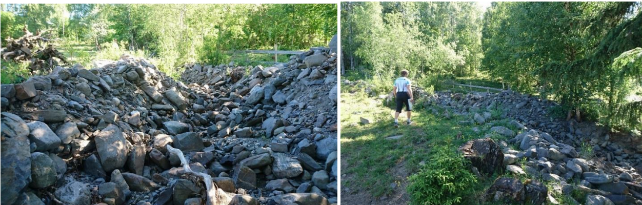
Figur 4.36 (Pkt. M5) Bilder tatt litt lenger nedstrøms enn i figur ovenfor, rett oppstrøms kryssing av traktorveg. Store mengder stein og erosjonsmateriale er gravd ut av bekkeløpet.
