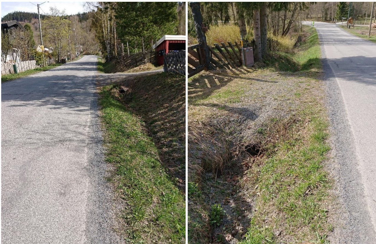
Figur 4.44 (Pkt. F4) Parti av Kringsjøvegen lenger nedstrøms der hvor Lundebekken krysser i kulvert gjennom vege (se figur over). Bildene er tatt i hhv oppstrøms og nedstrøms retning og viser begrenset med veggrofter hvis flomvann drenerer nedover her.
