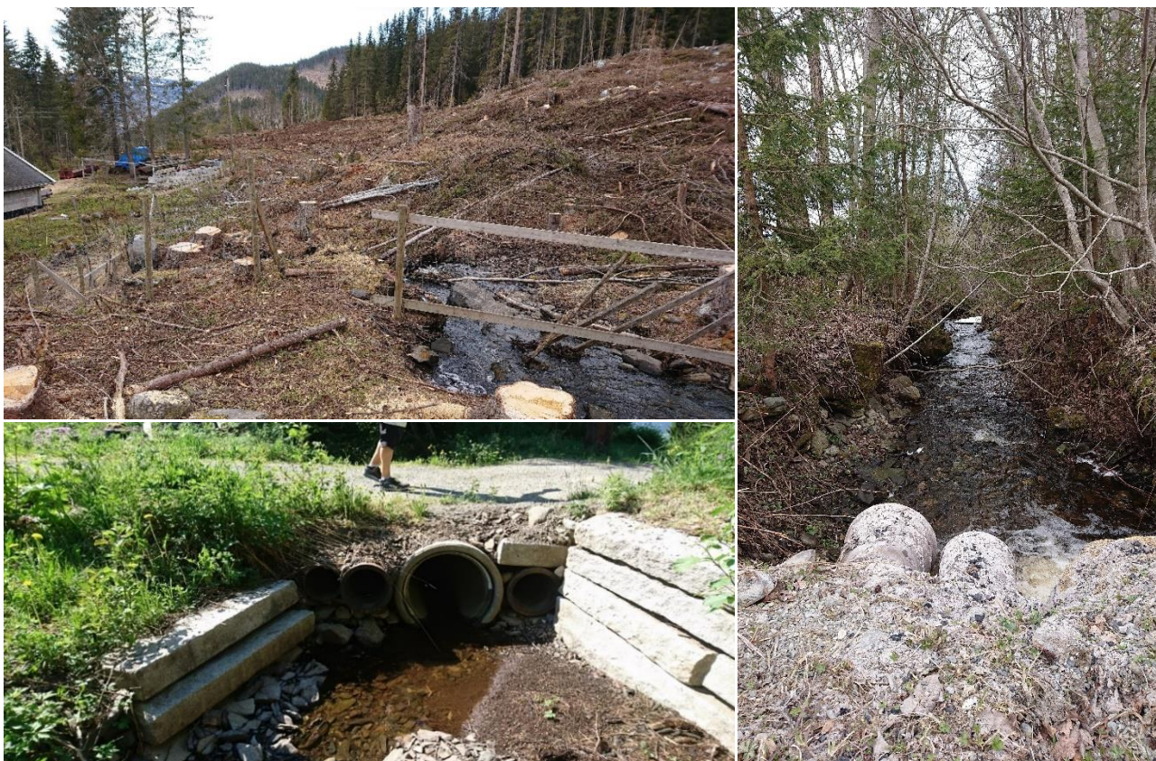
Figur 4.27 (Pkt. Ø2) Øverst til venstre ses 90 graders sving på bekken ovenfor husene innerst i Bergesvegen. Under vises stikkrenne under vegen ved Øverberget sett oppstrøms fra. Utløpet fra stikkrennene ses til høyre. Det er tydelige erosjonsskader rundt denne bekketrysningen.
