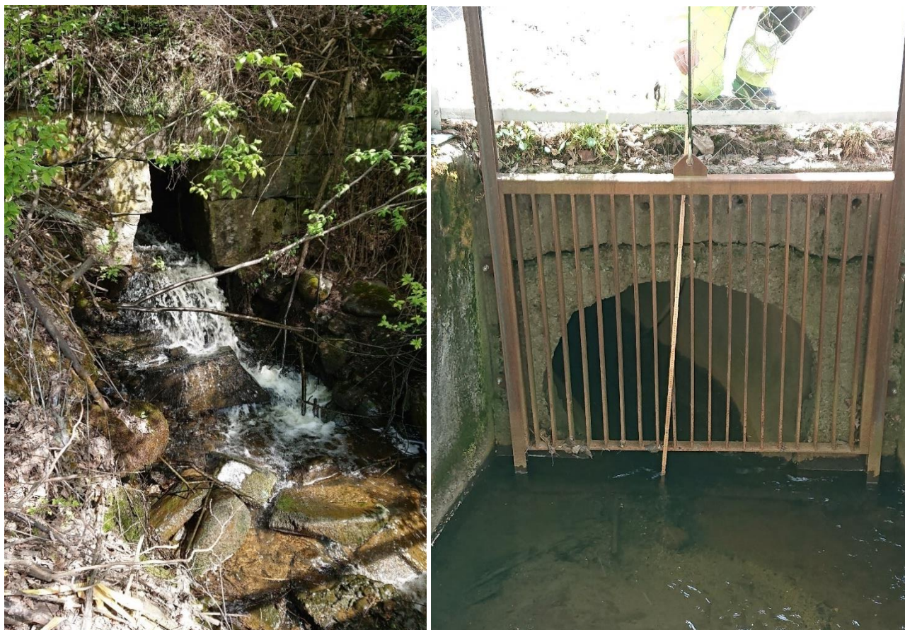
Figur 4.74 (Pkt. N7) Til venstre sees utløp av bekkelukkingen nedstrøms jernbanen ved Hovemovegen 1. Jernbanekulverten av murt stein er delvis rast ut på nedstrøms side. Til høyre vises selve inntaket til bekkelukkingen videre med gitterrist og manuelt vaiertrekk for heving av rista.
