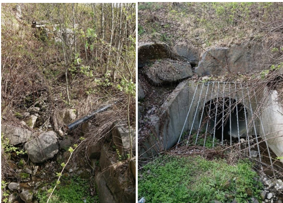
Figur 4.88 (Pkt. F16) Utløpet av murt kulvert gjennom jernbanen ved Hovemovegen 31 (oppstrøms Byggmax) kan skimtes i jernbanefyllinga i øvre del av bildet til venstre. Det er bratt ned til inntaket til bekkelukking (hvor bildet er tatt fra), som videre er lagt rundt Byggmax (på nordsiden). Inntaket (bilde til høyre) ligger nederst i en dyp forsenkning i skrånningen, som strekker seg fra jernbanen og ned mot Byggmax. Det munner ut en dremsledning (pre-isolert vannledning?) fra vannkum på hovedvannledningen rett ved. Inntaket har prefabrikkert vingemur med rist, og det er avlagret noe sediment og kvist/rask foran og inn på rista. Bekkelukkingen krysser E6 rett sør for gangkulvert og har sitt utløp ned mot Bæla oppstrøms vannverket i Korgen.
