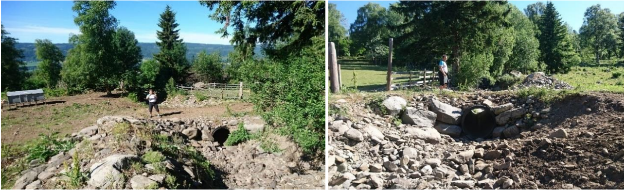
Figur 4.37 (Pkt. M6) Ved stikkrenne/kryssing av gårdsveg. Dyrka mark på nordsiden av bekken, og beite på sørsiden. Bilde til venstre er tatt fra oppstrøms side, mens det til høyre er tatt fra nedstrøms side. I 2014 gikk stikkrenna tett med erosjonsmateriale. Bekken ble ledet sørøver (mot/over beiteområdet) for å forhindre skader på eiendommene nedstrøms.
