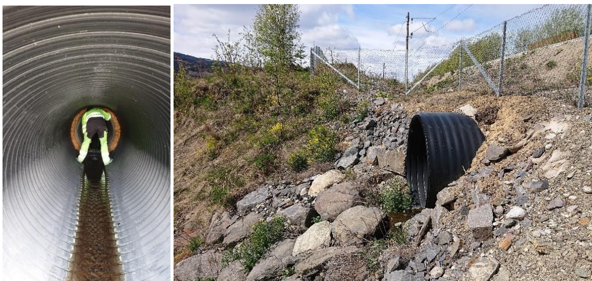
Figur 4.81 (Pkt. F12) Kulverten til "Skikstadbekken" under jernbanen er forlenget (skjøttet på) etter tidligere å ha vært skadet (utglidning); se venstre bilde. Utløpet vises til høyre.
