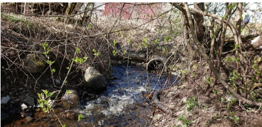
Figur 4.50 (Pkt. M13) Inntak til bekkelukkingen over Midtre Lunde og som etter hvert går i eiendomsgrensa mot Nordre Lunde. Her vil vannet føres over veien og nedover mellom bygningene nedstrøms hvis lukkingen går tett/får for liten kapasitet. Det vil føre til vann på avveie og erosjon.
