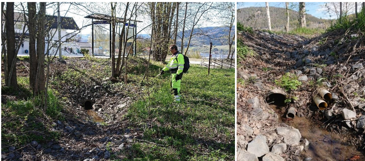
Figur 4.54 (Pkt. M16) Til venstre ses inntak til drenering fra dyrka mark oppstrøms Gamlevegen (Nordre Lunde) og flomløp fra bekkeinntak (se figur over). Røret har liten dimensjon og har antagelig lite fall, da vannet står i innløpet. Til høyre ses at flere drenerør fra dyrka marka ledes ut i grøfta. Inntaket har sannsynligvis ikke noe ekstra kapasitet til å fungere som et flomløp.
