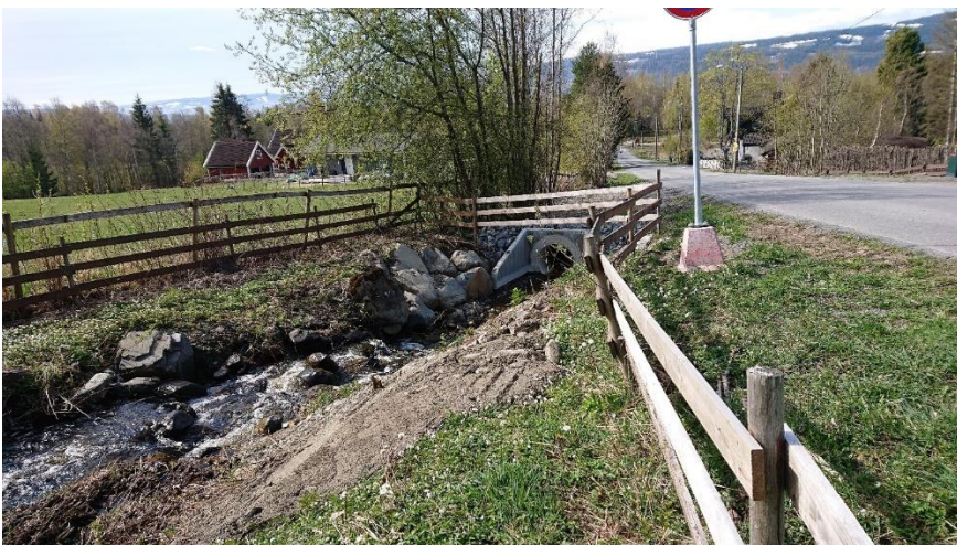
Figur 4.42 (Pkt. M10) Innløp til kulvert gjennom Kringsjøvegen, beliggende nederst på eiendommen Kringsjøvegen 185. Kulverten er nylig forlenget oppover langs vegen pga skade på vegen og fare for utglidning av vegen (etter 2014-flommen).
