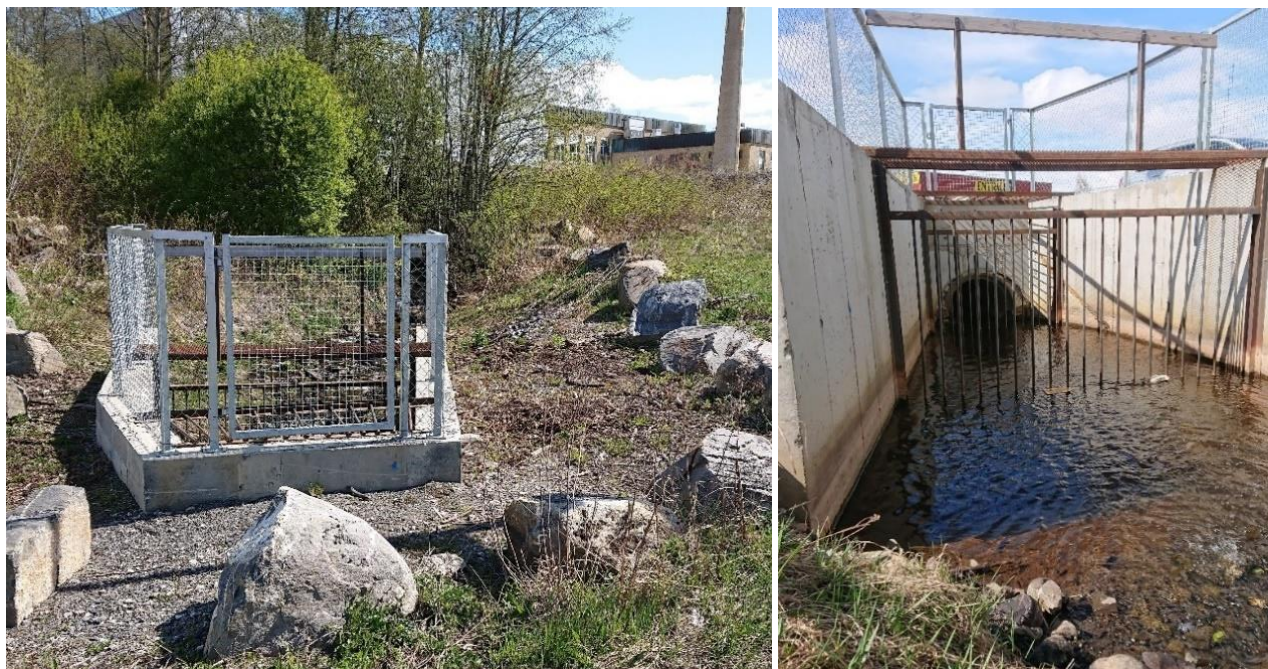
Figur 4.71 (Pkt. N5) Inntak for lukkingen av Lundebekken rett ovenfor Industrigata (sett hhv fra nedstrøms og oppstrøms side). Herfra er bekken mer eller mindre lukket helt ned til utløp i Lågen. Hvis denne tettes vil vannet drenere langs Industrigata og nordvestover.
