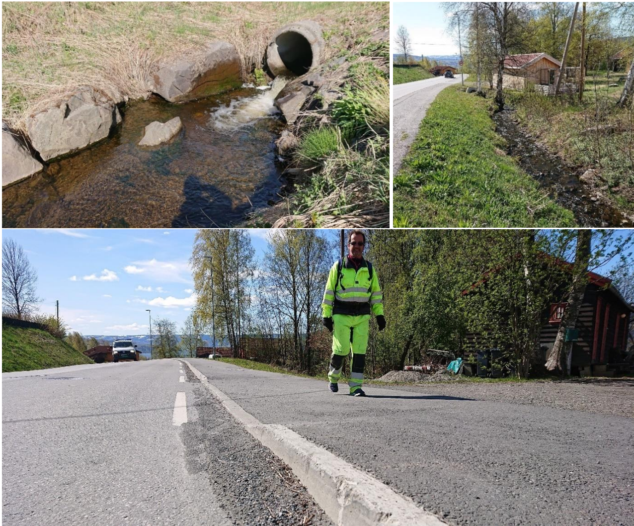
Figur 4.55 (Pkt. M17) Bilde øverst til venstre viser utløp kulvert/bekkelukking nedstrøms Gamlevegen ved Fagabergvegen. Steiner har glidd ut (undergravd?). Til høyre ses kort åpent parti før stikkrenne/bekkelukking forbi eiendommen Fagabergvegen 26. Hele strekningen er sårbar. På bilde under ses nedsenket kantstein og fortau ved innkjøring til eiendommen. Det vil være fare for at vann drenerer inn mot eiendommen hvis flomvann kommer ned Fagabergvegen og/eller at bekkelukkingen får for liten kapasitet.
