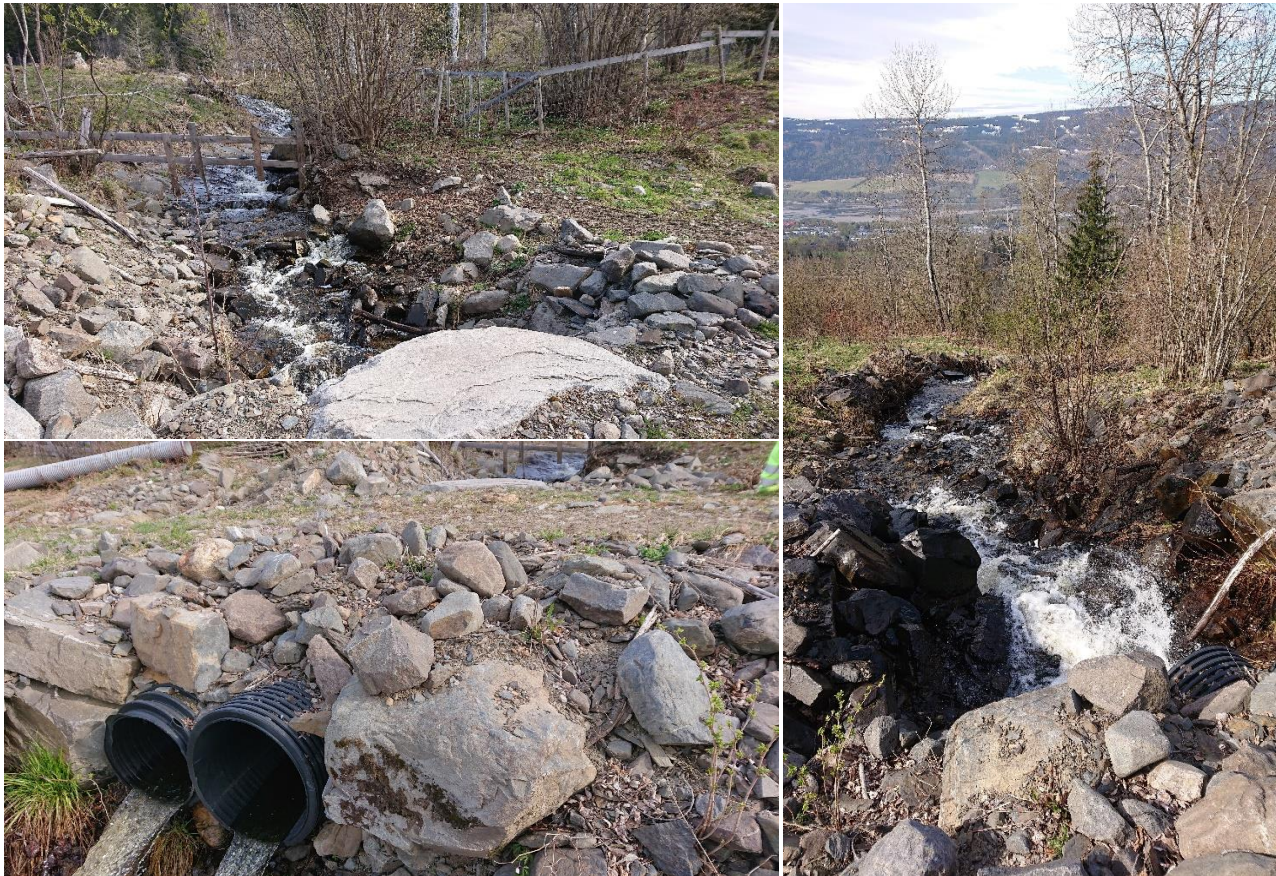
Figur 4.33 (Pkt. M3) Traktorveg nedstrøms Vesleberget krysser bekken ved Lundødegården. Mye massetransport med til dels stor stein, og innslag av bart fjell noen steder. De høyre bildene er tatt oppover fra hhv veg og nedstrøms veg. Høyre bilde viser nedstrøms veg.
