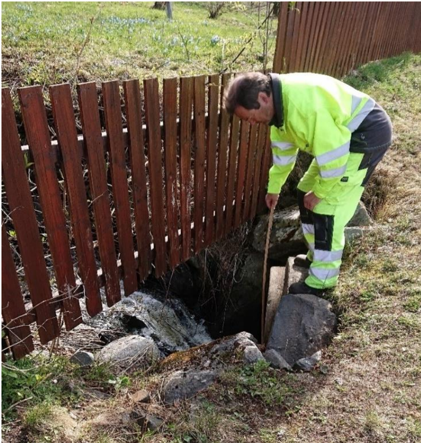
Figur 4.41 (Pkt. M9) Innløp til kulvert gjennom i grensa mellom Kringsjøvegen 187 og 185. Her er det utsatt for gjentetting/reduksjon av kapasitet ved massetransport i flomsituasjoner.
