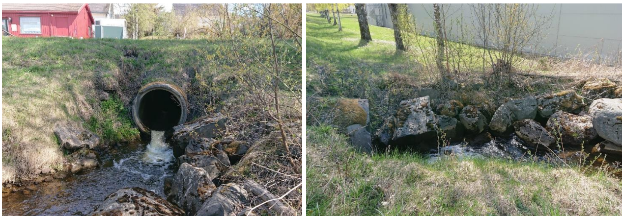
Figur 4.68 (Pkt. N3) Utløp fra bekkelukking nedstrøms Gudbrandsdalsvegen (rett ovenfor Byggmakker). Erosjonssikring på sørsiden av bekkeløpet er skadet, bl.a. har stor stein rast ut / er undergravd. Ved stor vannføring må «forbygningen» ta opp kreftene i vannet og lede det nordover i 90 ° sving. Hvis ikke sikringen er solid nok vil vannet flomme mot Byggmakker.
