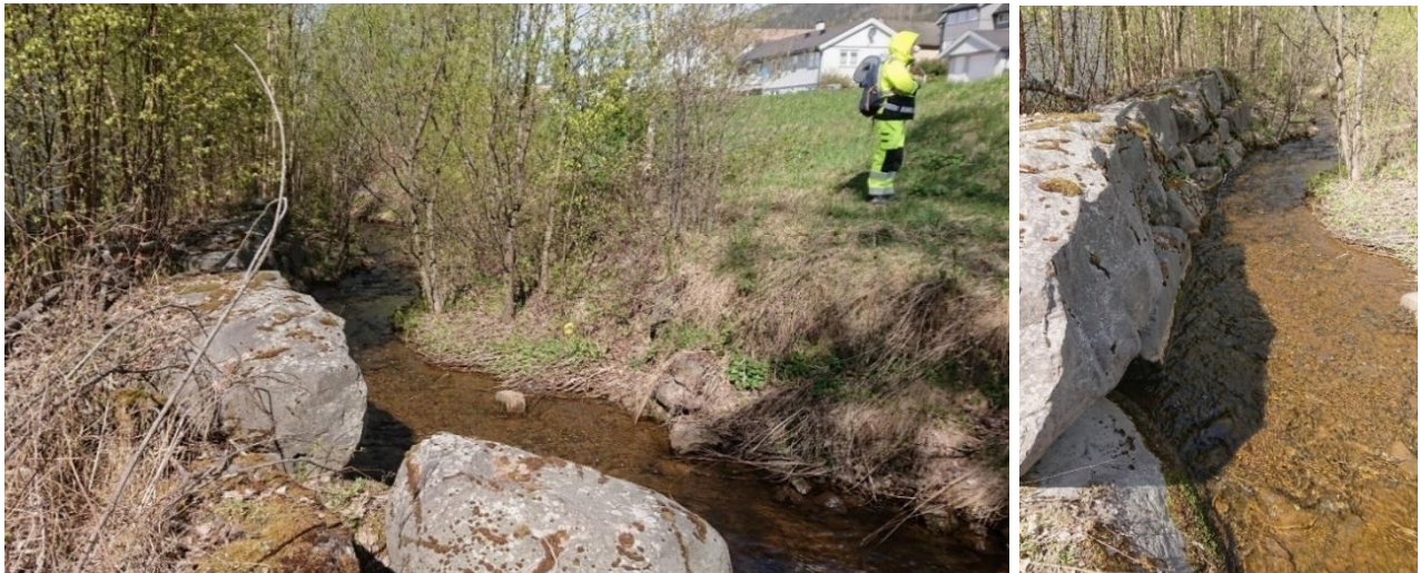
Figur 4.69 (Pkt. N3) Etter svingen, rett nedstrøms utløpet av kulverten, har det ikke vært like store krefter på forbygningen mot Byggmakker.
