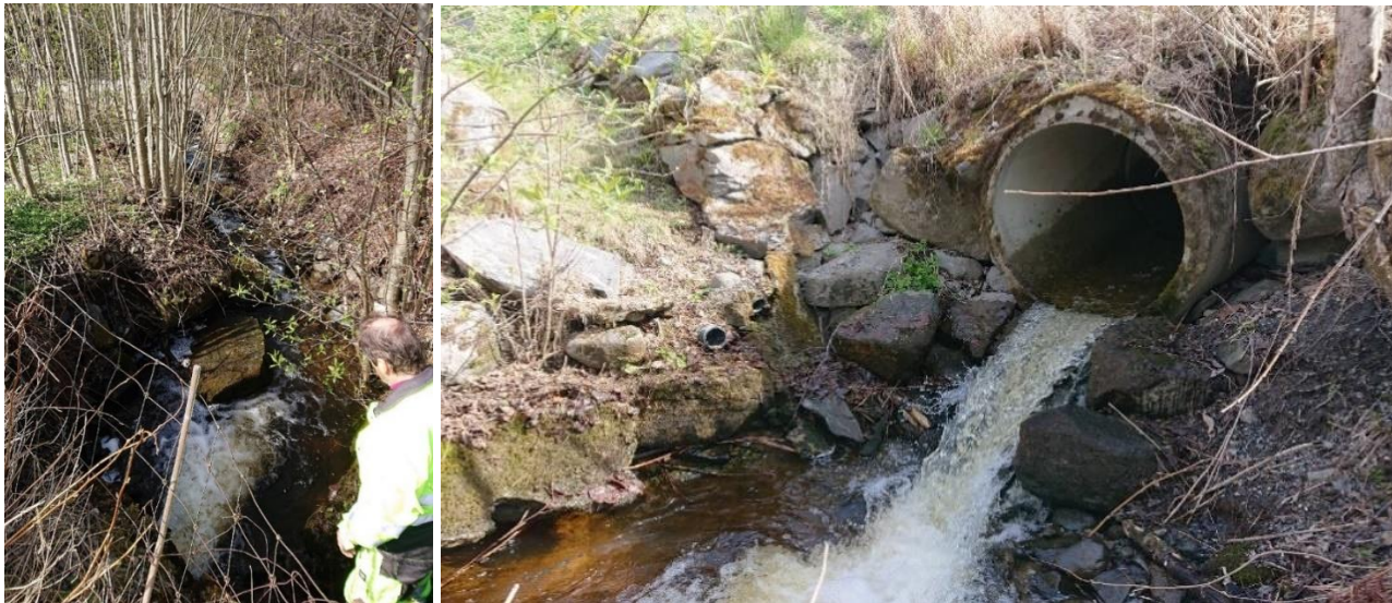
Figur 4.43 (Pkt. M11) Utløp av kulverten gjennom Kringsjøvegen. Det er mangelfull erosjonssikring ved utløp.
