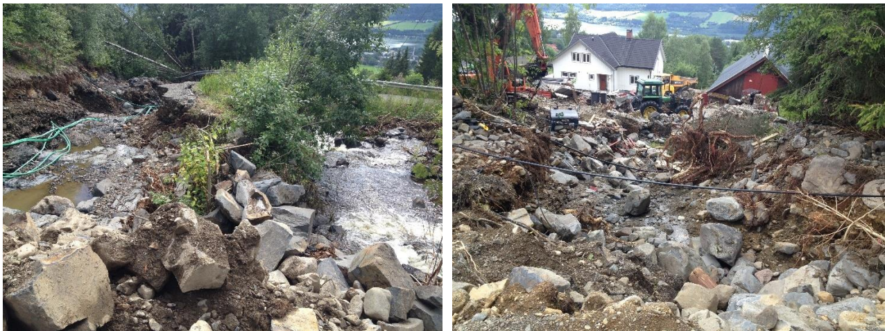
Figur 3.1 Til venstre vises hvor Bæla tok på avveie ut fra sitt løp og drenerte langs lokalveien inn mot nedbørfeltet til Lundebekken. Vannet eroderte bort hele asfaltdekket og grov bort hele veien. Til høyre sees hvor det meste av vannet drenerte tilbake igjen mot Bæla lenger nedstrøms. Det førte til store skader både på infrastruktur og eiendom.
