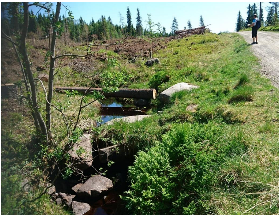
Figur 4.22 (Pkt. 2-1) Bilde tatt mot Åsmyra på oppstrøms side av stikkrenne gjennom Åsstuevegen. Oppstrøms dette punktet er det et søkk i terrenget hvor det er mulig å anlegge terskler og fordrøye flomvann.
