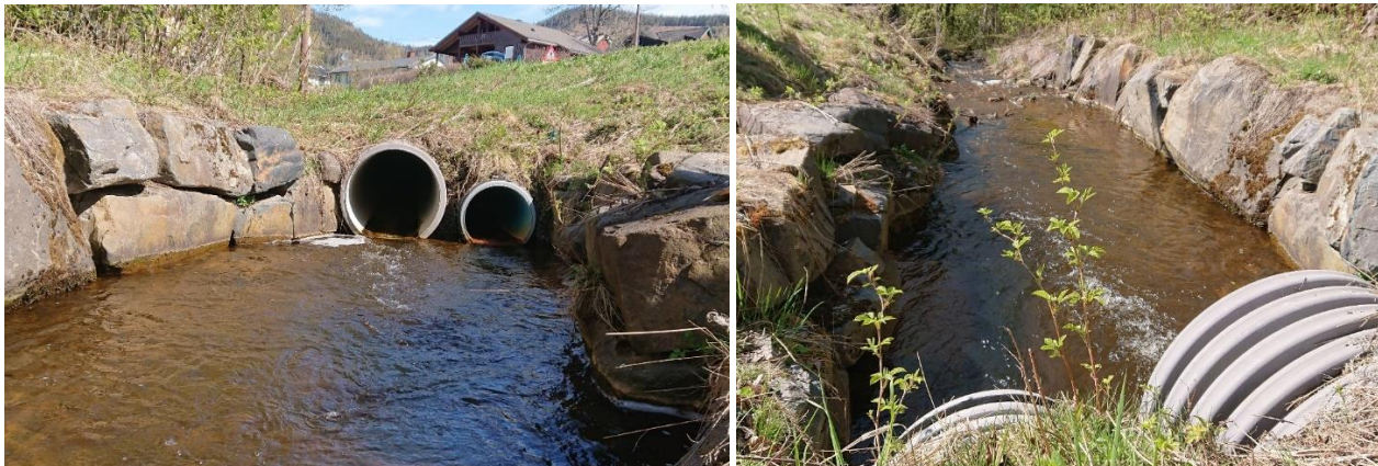
Figur 4.56 (Pkt. M18) Utløp bekkelukking fra Lundebekken (størst dimensjon) og «Fakstadbekken», sett hhv fra nedstrøms og fra utløpet og nedover. Erosjonssikringen/steinblokkene er utsatt for erosjon/utvasking. Det er bl.a. en løs stein «på vippen» ut i bekken. Begge utløpene blir sannsynligvis dykket i en flomsituasjon og vil da få redusert kapasitet.
