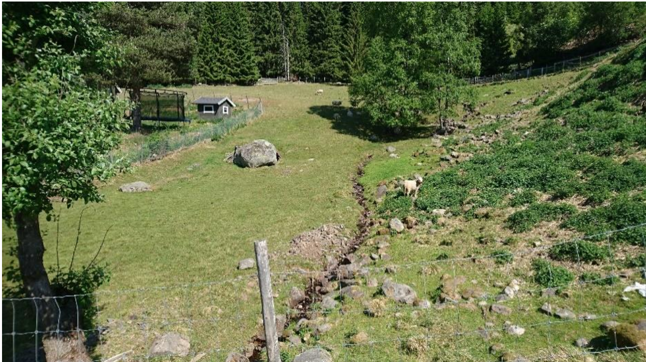
Figur 4.23 (Pkt. 2-2) Kryssing Olasvevegen sett fra veifylling og oppover. Det var noe erosjon og avlagrede stein og grus i bekkeløpet i skogsområdet oppstrøms. Vegfylling vil kunne være sårbar ved gjentetting/for liten kapasitet av stikkrenne ved en ekstremhendelse.
