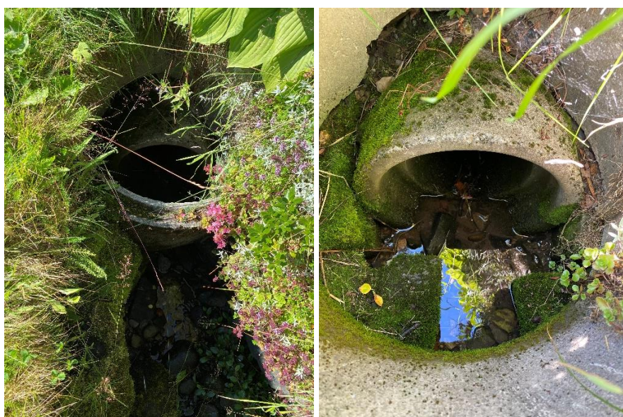
Figur 4.29 (Pkt. M0) Flomveiskart som viser hvor flovann sannsynligvis drenerer videre (inn mot huset og til bygningene nedenfor) hvis bekkelukkingen (de to nederste bildene) under Bergesvevegen 128 ikke har tilstrekkelig kapasitet. Bildet øverst til høyre viser flombekken fra eiendomsgrensa (gjerdet) og mot bekkelukkingen sett nedstrøms fra.
