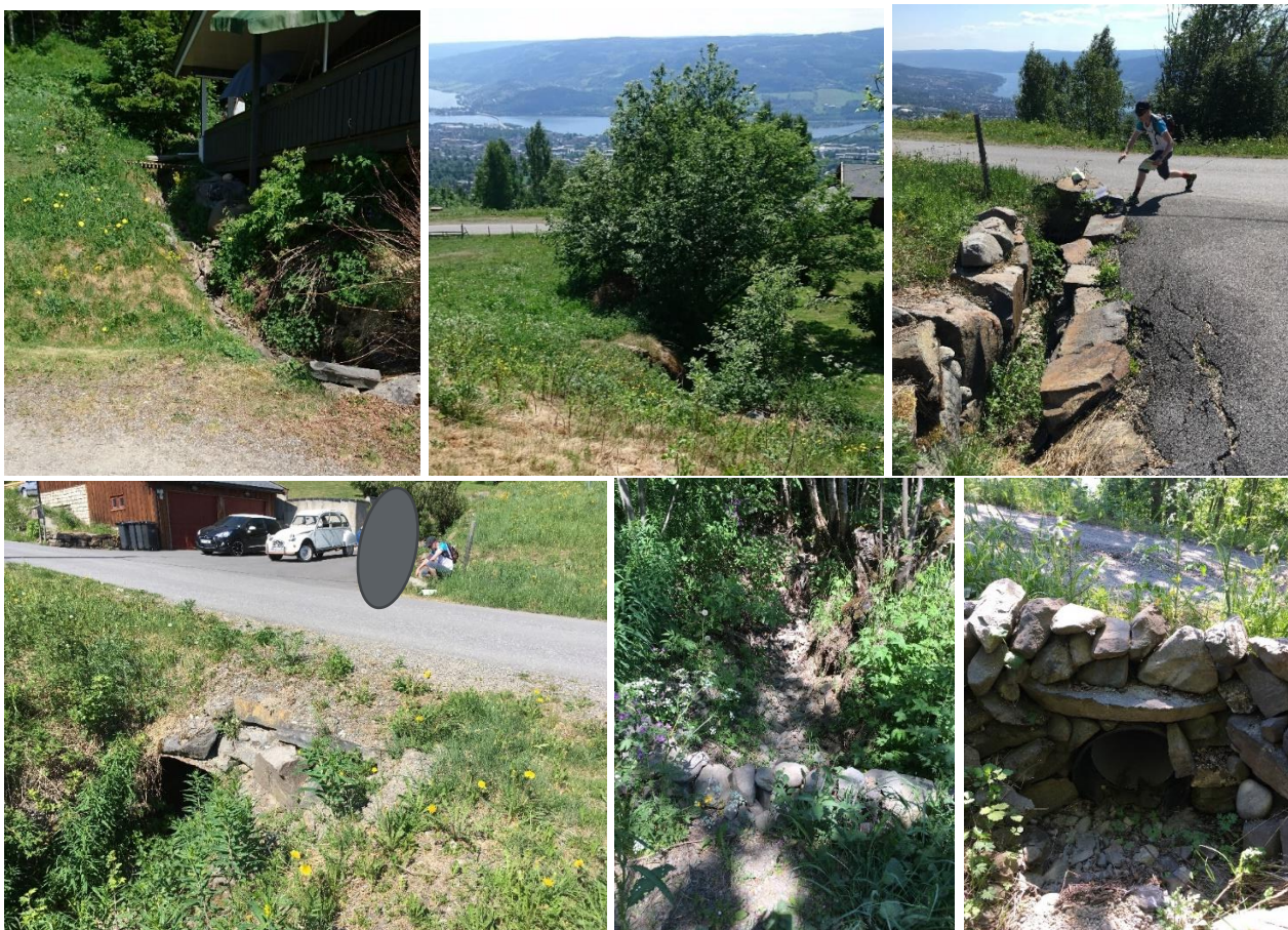
Figur 4.57 (Pkt. F1) "Fakstadbekken" fra øvre del ved Løkken og nedover via tre veikrysninger (fra bildet øverst til venstre mot høyre og det samme nederst). Dårlige dreneringstiltak med lite vedlikehold. Sårbart område med fare for vann på avveie, bl.a. mot bygningene ved Halvorstuen og deretter mot Lundebekken.
