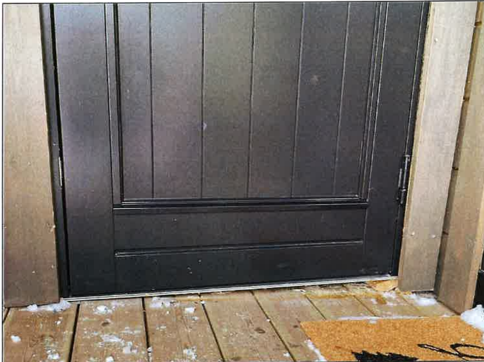
Figur 10: Setningsskader på inngangsparti.
