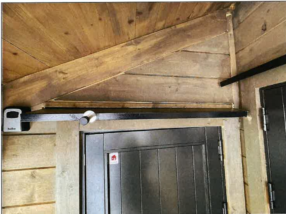
Figur 11: Setningsskader på inngangsparti.
