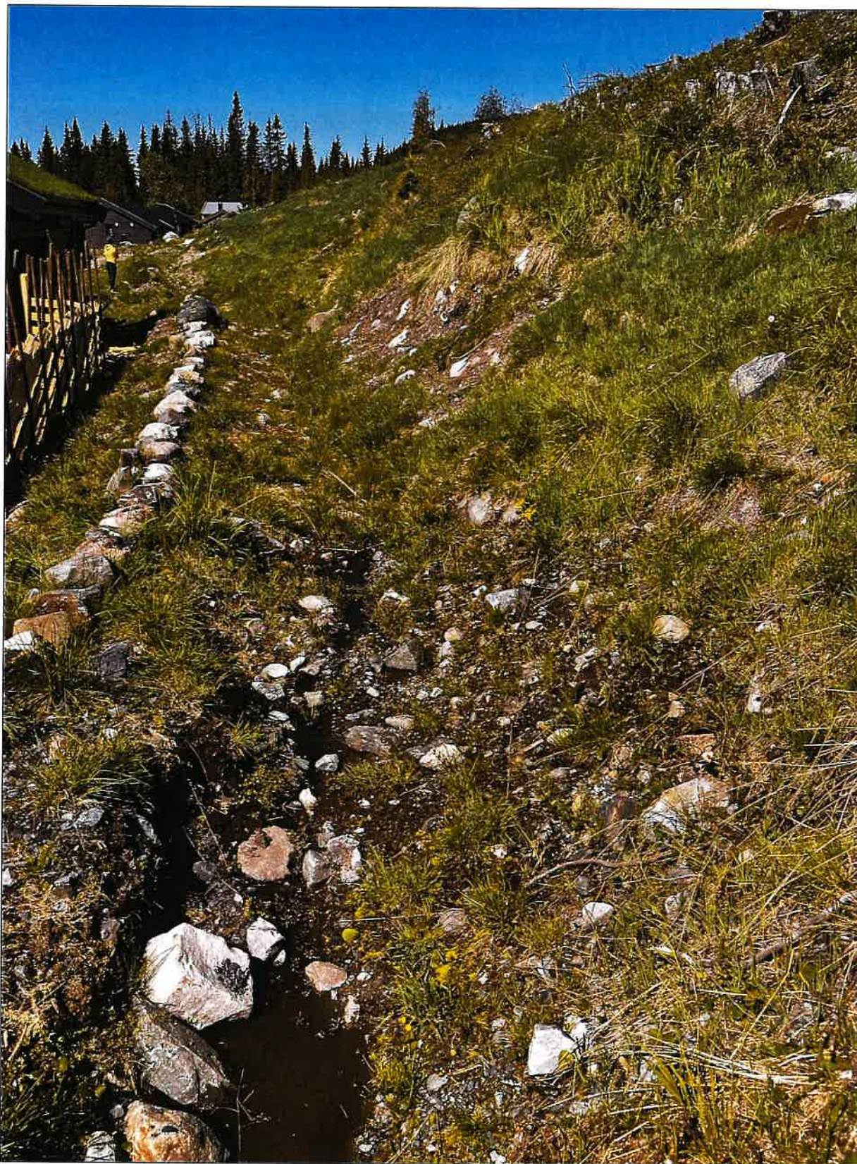
Figur 16: Lekkasje fra dammens sørside.
