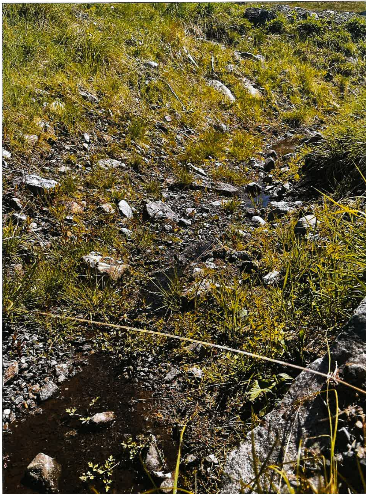
Figur 17: Lekkasje fra dammens sørside.
