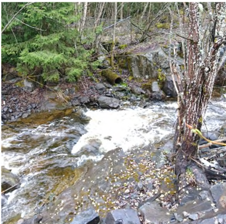
Figur 8. Utløp av overvannsledning på sørsiden av Åretta. Betongledning begrodd med mose. Foto fra befaring i mai 2017.
