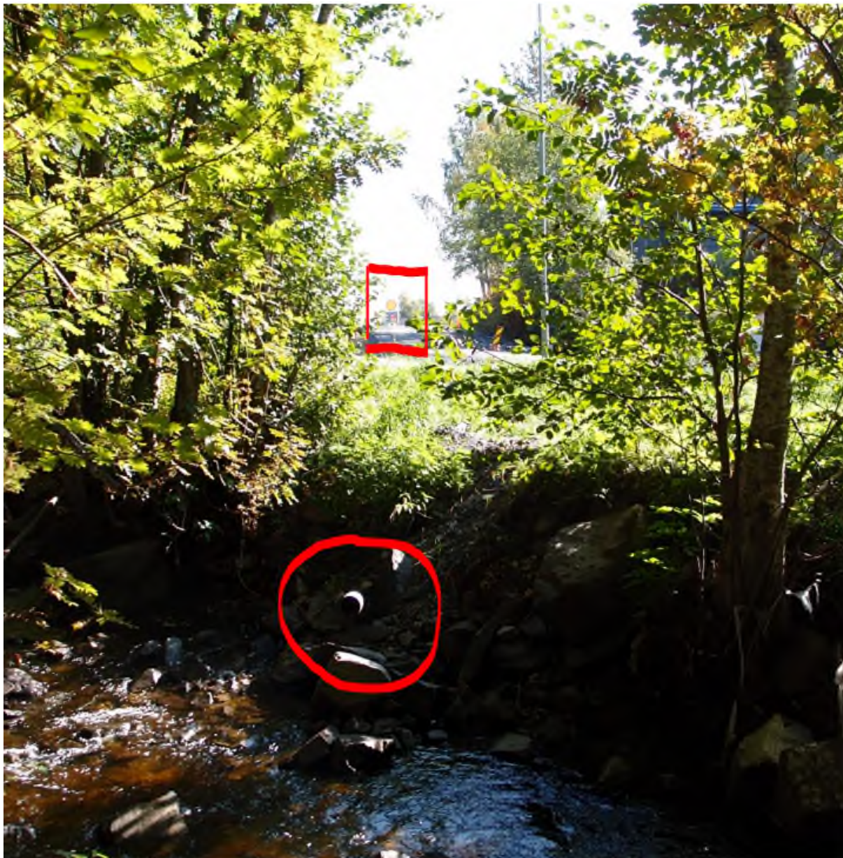
Figur 5. Utløp av plastledning (antatt overvann) nedstrøms gangbrua som går over Messenlivegen. Fra posisjonen hvor bildet er tatt kan man skimte skiltet som angir bensinstasjon ved Røyslimoen. Foto fra befaringsmai 2017.
