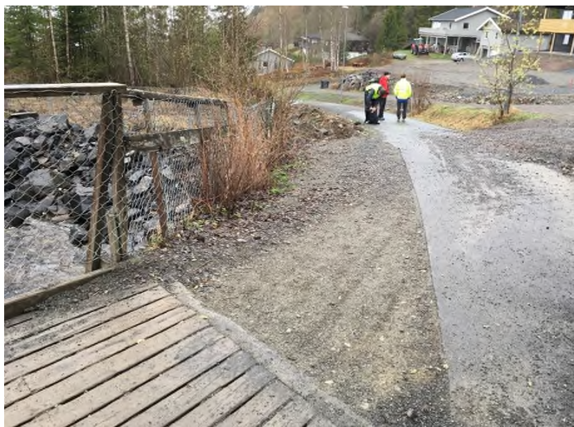
Figur 26.4. (pkt. 4 og 5) Viser brua mellom vegen Langbakken og Skogforvalter Lies veg, hvor manglende kapasitet medfører risiko for at flomvann vil bli ledet nordover og vest/ned langs Langbakken. Her gikk elveløpet tidligere. Flomvannet vil kanskje ledes tilbake mot elveløpet nedstrøms kommunalt høydebasseng, men sannsynligvis vil det også ledes ned gjennom bebyggelsen i Langbakken og Høstmælingsvegen, samt ned stien langs elva mot Høstmælingsvegen.
