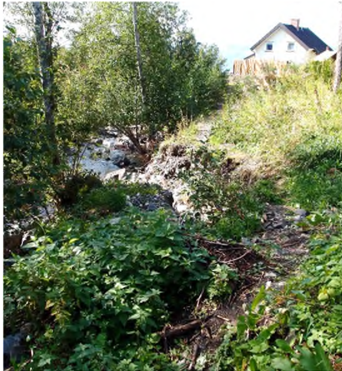
Figur 28.4. (Mellom pkt. 6 og 7) Viser situasjonen på strekningen mellom det kommunale høydebassenget i Langbakken og ned mot Høstmælingsvegen nr. 30 (ses oppe til høyre i bildet) etter flommen i juli 2014. Gangsti og nordre elvebredd er sterkt erodert (Foto: Lillehammer kommune).
