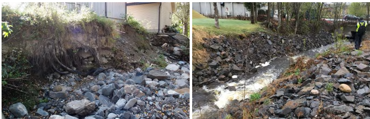
Figur 40.4. Bildet til venstre viser pkt. 13, med erosjonsskader i søndre elvebredd oppstrøms Fredrik Colletts veg, etter flommen i 2014 (Foto: Lillehammer kommune). Bilde til høyre er fra like oppstrøms kulverten gjennom Fredrik Colletts veg, der det er en relativt bratt elvebredd mot sør, med løse masser bestående av grus og stein i varierende størrelse, og enkelte steiner opp til ca. 0,5 meter.
