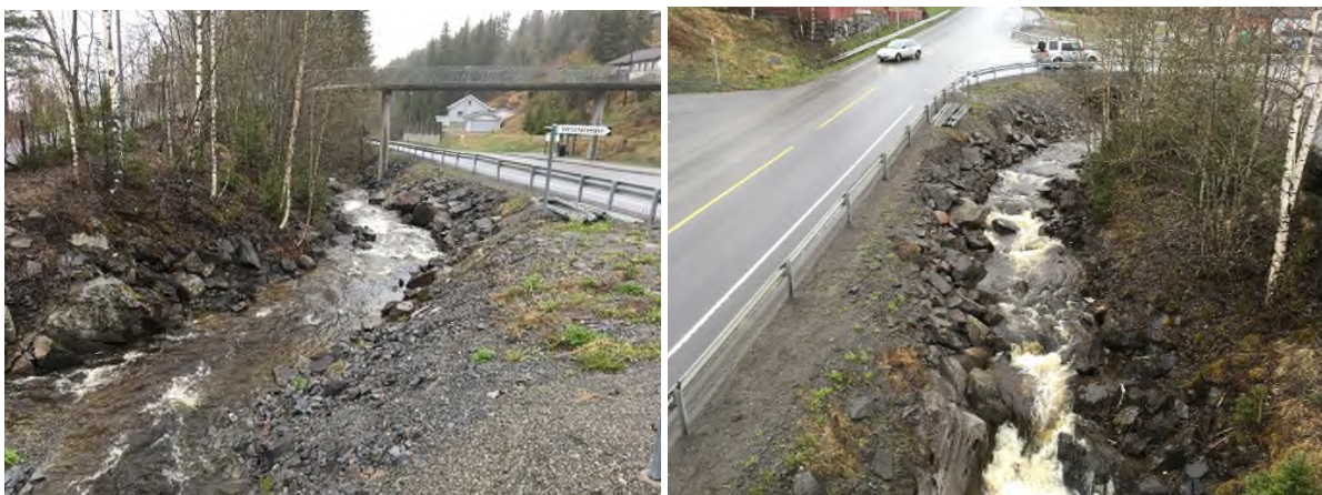
Figur 21.4. (Pkt. nr. 1) Venstre bilde: Viser erosjonsutsatt område mot Messenlivegen (til høyre i bildet) Høyre bilde: Bilde tatt fra gangbrua oppover mot avkjøringen til Røyslimoen. Det er mye løsmasser i og langs elva på denne strekningen.
