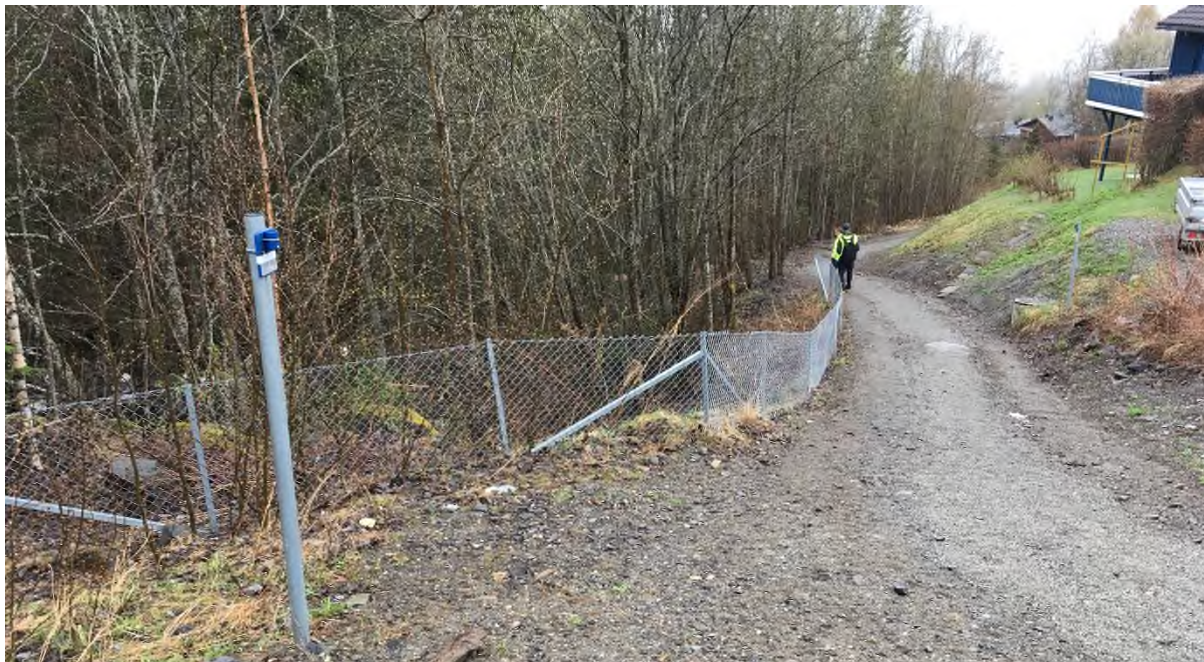
Figur 34.4. (Pkt. 8) Viser turveg på nordsiden av elva nedstrøms Høstmælingsvegen. Det er her risiko for vann på avveie fra kulvert/kryssing Høstmælingsvegen, som omtalt i kap. 4.8.1. Turvegen er bratt og med grusdekke, og er svært utsatt for erosjon, selv ved mindre vannmengder. I turvegen ligger det både VA-ledninger (hovedledning) og nyere høgspenkabelanlegg; se kap. 4.9. Bilder tatt av Lillehammer kommune etter 2014-flommen viser hvilke erosjonsskader som kan oppstå i gangvegen (se Figur 37.4).
