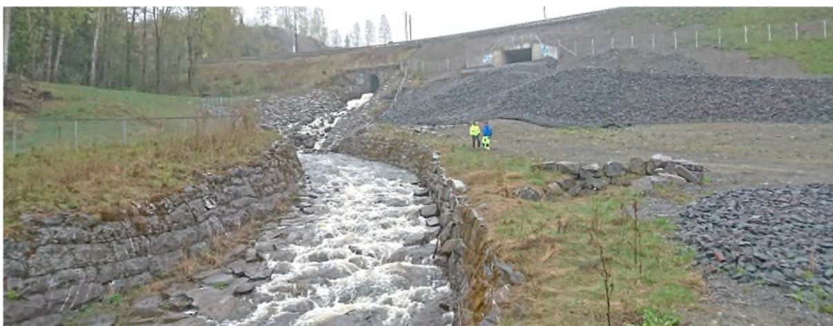
Figur 62.4. Viser strekningen der Åretta er kanalisert nedstrøms jernbanen. Eldre muring ses i nedre del, mens i øvre del, mot gammel kulvert, er det bygd ny erosjonssikring etter 2014. Utløpet til ny kulvert ses til høyre.
