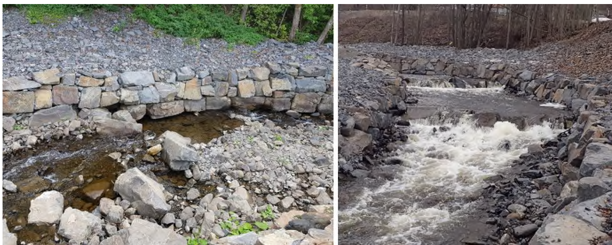
Figur 22.5. Bildet til venstre viser en erodert terskel nedstrøms utløpet av kulverten ved Fredrik Colletts veg i 2018, bildet til høyre viser det samme området i 2016.
