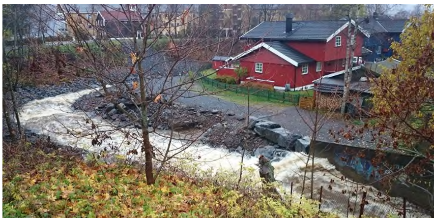
Figur 45.4. (Pkt. 15/16) Viser erosjonsutsatte skråninger nedstrøms Fredrik Colletts veg. Fra utløp av kulverten presses vannet opp/mot enden av betongmuren (foto: Lillehammer kommune, okt. 2014). Øverst i bildet ses erosjonsutsatt høy jordskråning mot Skogli (gule bygninger).
