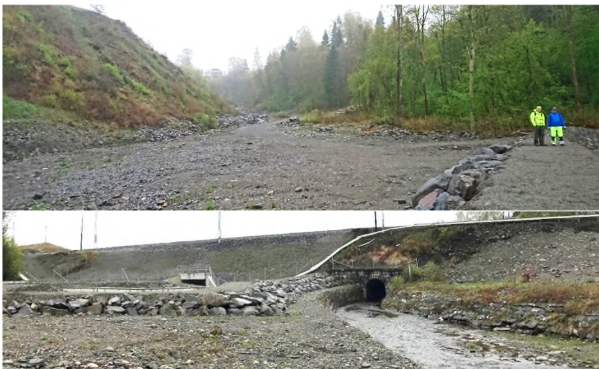
Figur 59.4. (Pkt. 28 - 29) Øvre bilde er tatt oppover dalen fra jernbanen. Her vider dalen seg ut til ei lita elveslette som avgrenses i nedre kant av jernbanefyllinga. Nedre bilde er tatt mot inntak av kulvertene under jernbanen. Etter flommen i 2014 er det bygget ny kulvert sør for den eksisterende. I 2018 pågår det arbeid med å legge elva over til ny kulvert, etablere terskel for håndtering av erosjonsmasser, samt plastring av elveløpet et stykke oppstrøms. Ny betongkulvert skimtes bak midlertidig fylling til venstre for gammel kulvert i nedre bilde.
