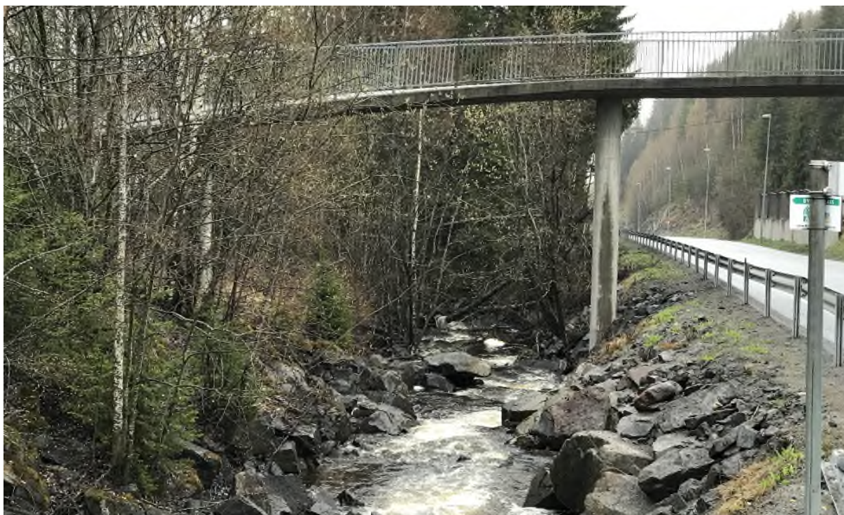
Figur 2.5. Viser mangelfull sikring av Messenlivegen langs Åretta.
