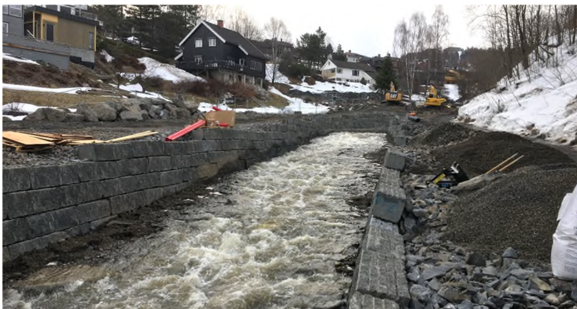
Figur 50.4. (Pkt. 19/20) Bilde fra utførelsen av erosjonssikringstiltak i april 2018 ved eiendommene langs Holtevegen nord for Åretta, nedstrøms gangbru. Bildet er tatt oppover mot gangbru, som lå omkring der hvor gravemaskiner ses i bilde. Gangveg, hvor VA-ledninger ligger, gjenoppbygges til høyre for elva.
