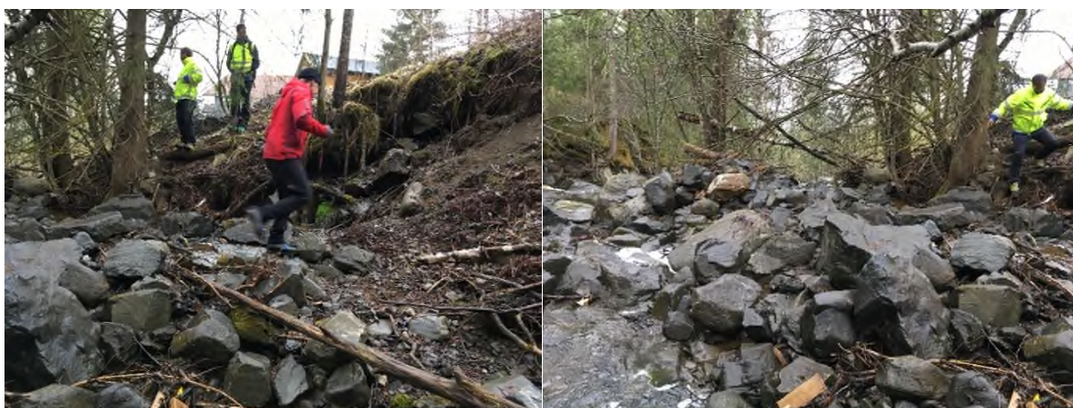
Figur 35.4. (Pkt. 9) Viser området nedstrøms foss/stryk, mellom bebyggelsen i Høstmælingsvegen og i Bratta, der det er en del erosjon og utvasking, samt påbegynnende utglidninger i nordre bredd mot turveg (oppe til høyre i bildene). Det er også avlagret til dels stor stein, trestammer, røtter og kvist.
