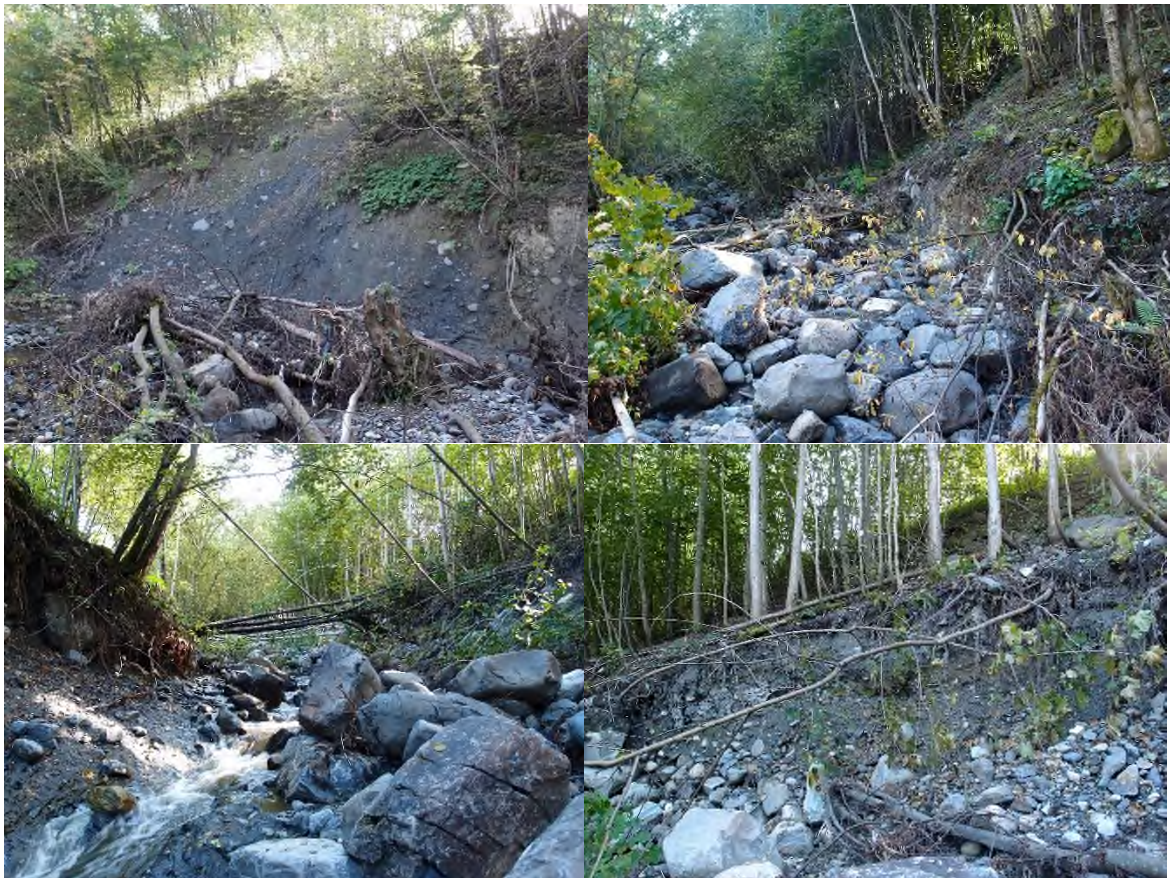
Figur 48.4. (Pkt. 17/18) Utvalg av bilder fra tiden etter flommen 2014 (foto: Lillehammer kommune), som viser erosjonsproblematikk, bratt skråning mot sør og innslag av mjøslreire.
