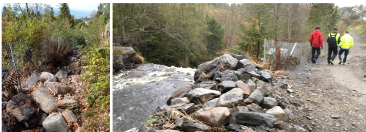
Figur 37.4. Venstre bilde viser gangveg utvasket under flommen i 2014 (Foto: Lillehammer kommune). Bilde til høyre er fra samme sted under befaring i mai 2017.
