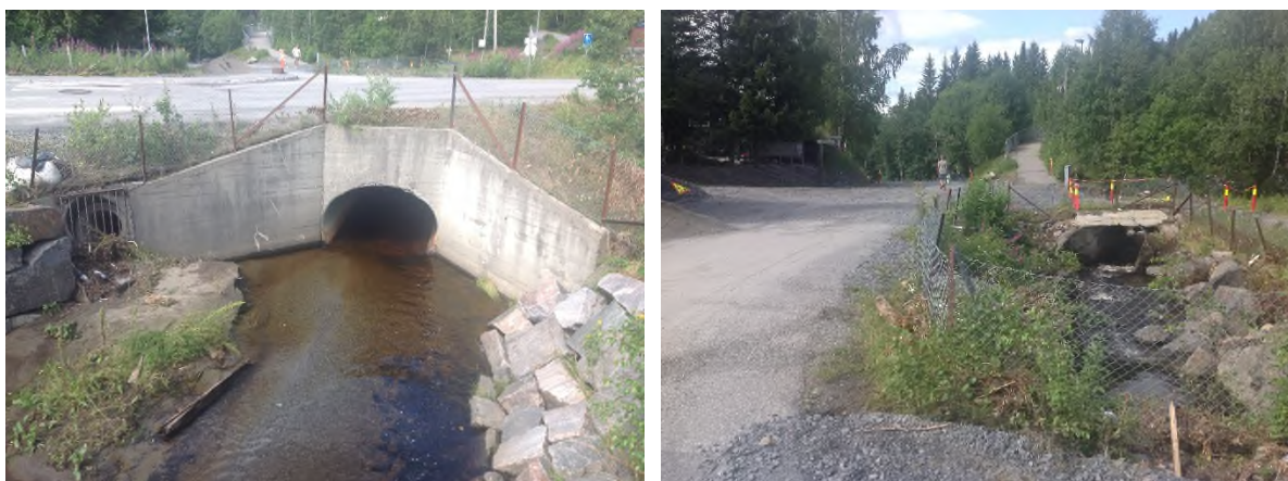
Figur 3.3 Viser de to siste bekkelukkingene/kulvertene for utløpet til Åretta fra Røyslimoen. Det ble store erosjonsskader også nedstrøms da flomvannet pga. manglende kapasitet på kulvertene rant over og tok på avveie, bl.a. ned Skogforvalter Lies veg (der personen midt i høyre bilde går, som er samme område som på forsidebildet).
