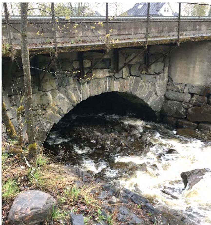
Figur 52.4. (Pkt. 22) Viser steinmasser ved innløp til / inn under bru ved Hamarvegen som fører til redusert kapasitet. Like oppstrøms er nordre bredd utsatt for erosjon og mulig risiko for mindre utrasing.
