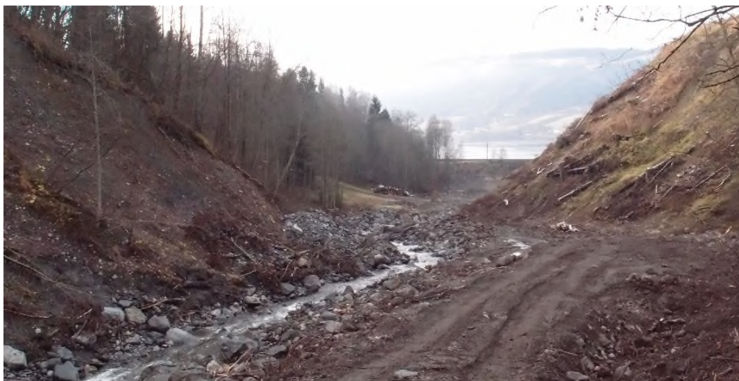
Figur 56.4. (Pkt. 25/26) Bilde tatt nedover mot fyllinga hvor jernbanen ligger (den kan skimtes nederst i dalen). Det er etablert anleggsveg langs nordre elvebredd i forbindelse med utbedringsarbeider. Ras/utglidninger ses i søndre bredd/skråning (Foto: Lillehammer kommune).
