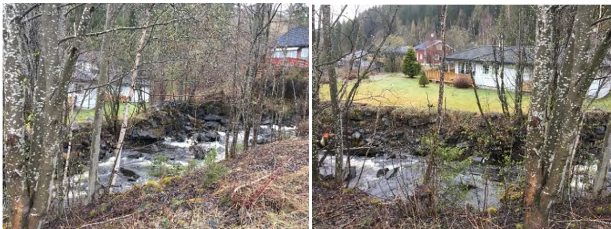
Figur 24.4. (Mellom pkt. 3 og 4) Viser lave bredder med voll på nordre side ved Skogforvalter Lies veg og Langbakken 64. Venstre bilde sett motstrøms, høyre bilde sett medstrøms. Langbakken 64 synes å ligge lavere enn elva og elvebreddene bærer preg av erosjon. Ved Langbakken 64 krysser også VA-ledninger elva.
