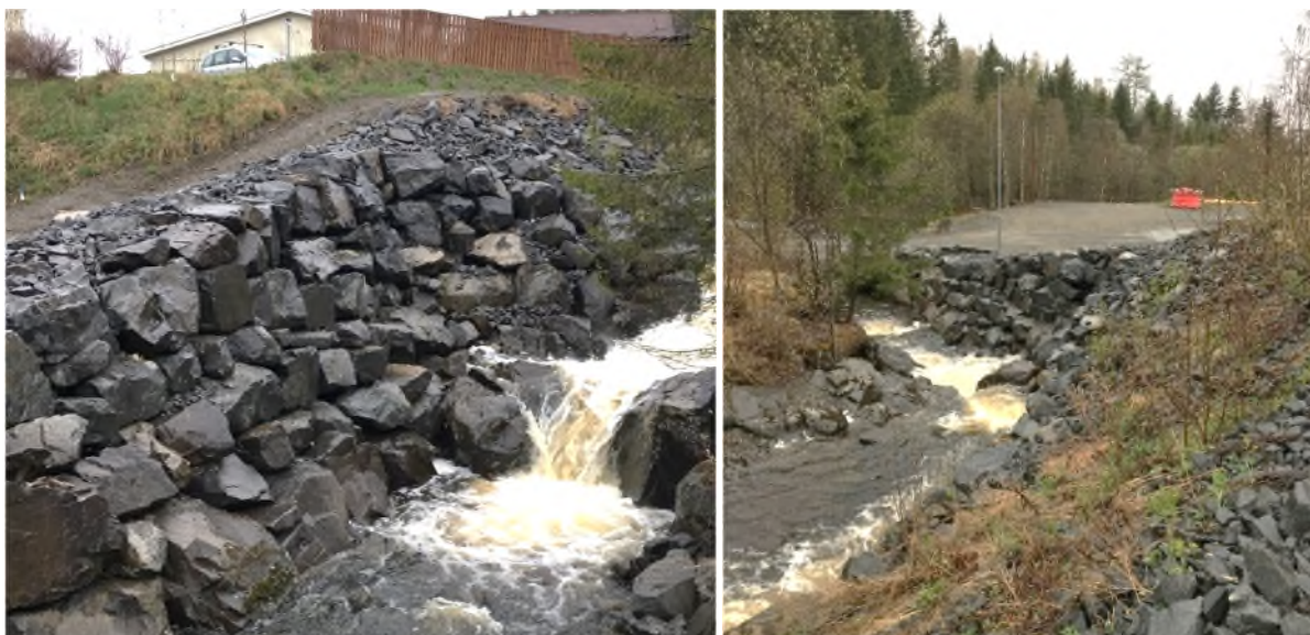
Figur 31.4. Viser området rett oppstrøms kulvert i Høstmælingsvegen hvor elva svinger og faller brått ned mot kulverten (pkt.7). Det er plastret med stein av varierende form og størrelse (opp til ca. 0,5 x 1 m). Det er risiko for at sikring vil kollapse ved stor flom, slik at kulverten kan gå tett. Det er også stor risiko for at flomvannet vil renne over gruset plass og ned turveg langs nordre bredd (nedstrøms Høstmælingsvegen); se neste kapittel (pkt. 8).
