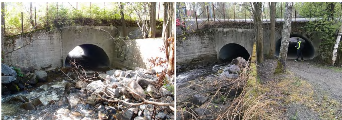
Figur 41.4. (Pkt. 14) Viser at det ble avlagret steinmasser ved innløpet til kulverten i 2014-flommen. Ved eventuell manglende kapasitet og/eller gjentetting av kulverten vil flomvann kunne overtoppe betongmuren som skiller hovedløpet fra en gangkulvert, som ligger parallelt nord for hovedløpet (Foto: Lillehammer kommune).
