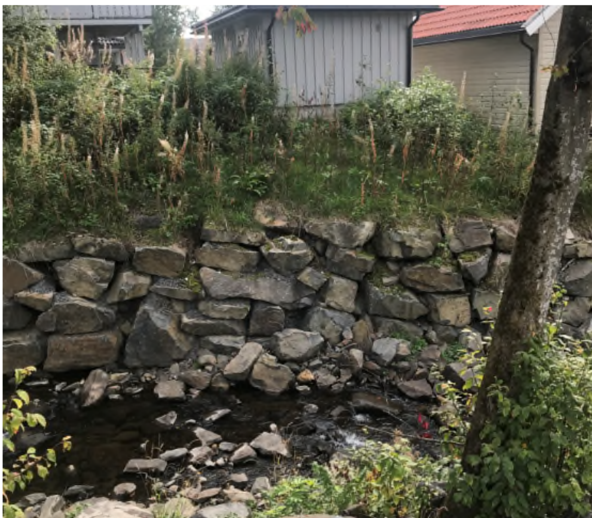
Figur 19.5. Mur på venstre side av elva oppstrøms Fredrik Colletts veg, som er delvis utrast, har store fugeåpninger og antagelig for små stein i filterlaget.
