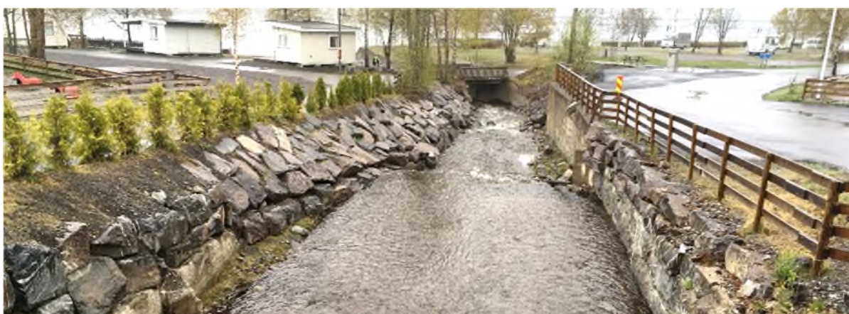
Figur 64.4. Bilde tatt nedover mot utløpet i Mjøsa fra Dampsagvegen. Viser varierende erosjonssikring på strekningen med både eldre steinmuring, plastring etter 2014-flommen, betongmur, samt elvebredd bestående av jordmasser.
