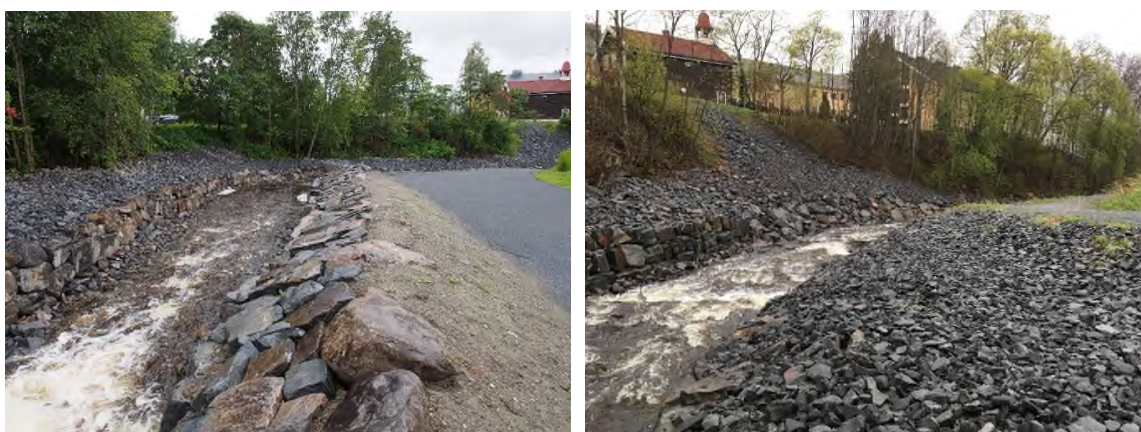
Figur 46.4. (Pkt. 16) Bildet til venstre viser elveløpet som svinger til høyre mot erosjonsutsatt yttersving ved Skogli. (Foto: Lillehammer kommune). Bilde til høyre er fra utløp av høyresvingen. Det er benyttet grovpukk/sprengstein i reparasjonene etter flommen i 2014.
