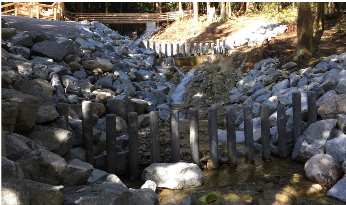
Figur 20.5. Massefang og drivgodssperrer i serie. "Rist" er etablert av kraftige metallrør med god forankring. Bunn og sider på både oppstrøms og nedstrøms side er sikret med steinplastring. (Foto: District of North Vancouver, 2017).
