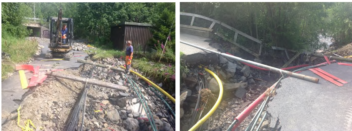
Figur 1.3 Viser noen av de store skadene på infrastrukturen der Askjellrubekken drenerte ned til Røyslimoen, rett oppstrøms prosjektområdet for Åretta.
