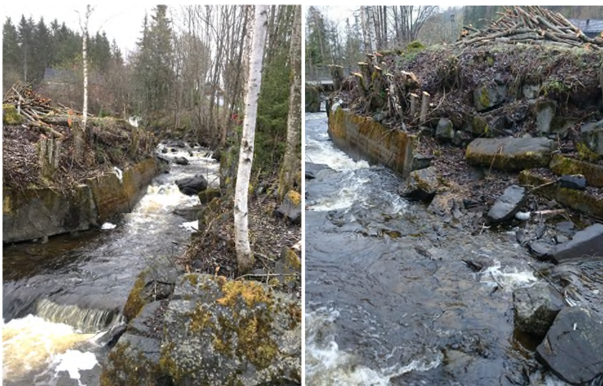
Figur 25.4. Viser at det ned mot brua (i pkt. 4) er betongmurer i varierende forfatning på nordsiden (ved Langbakken 64). Rett oppstrøms brua er det fjell i dagen. I venstre bilde ser en oppover fra brua, mens en i høyre bilde ser nedover mot brua.
