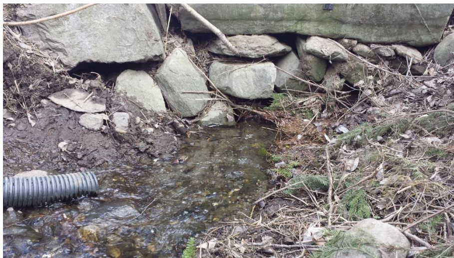
Figur 3-43: Innløp stikkrenne ( \varnothing 250\text{mm} DV nede i gjørme) under innkjøring til Øvre Ravneberg
