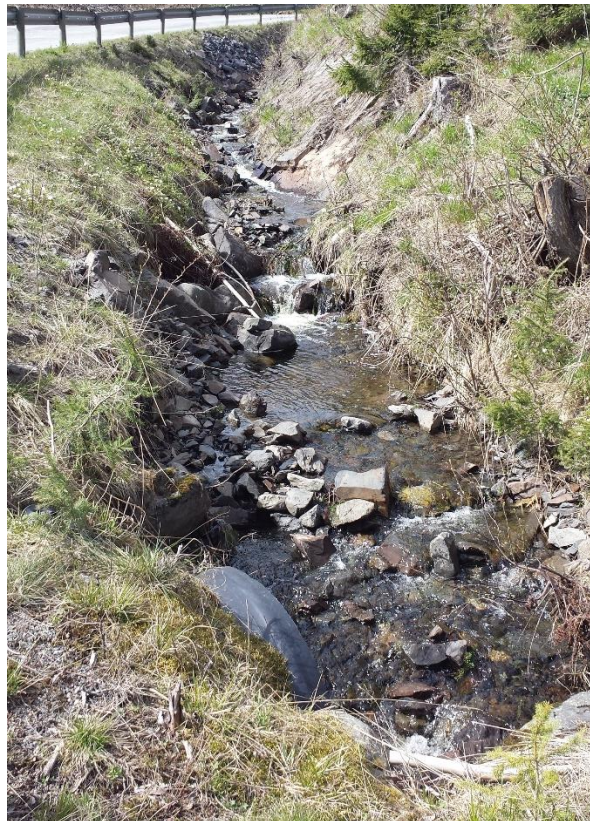
Figur 3-16: Innløp av \varnothing 600 mm DV stikkrenne under Saksumdalsvegen og bekkeløp i vegggrøft sett oppstrøms kryssing. Noe erosjonssikring er utført, men er mangelfull på noen strekninger.
