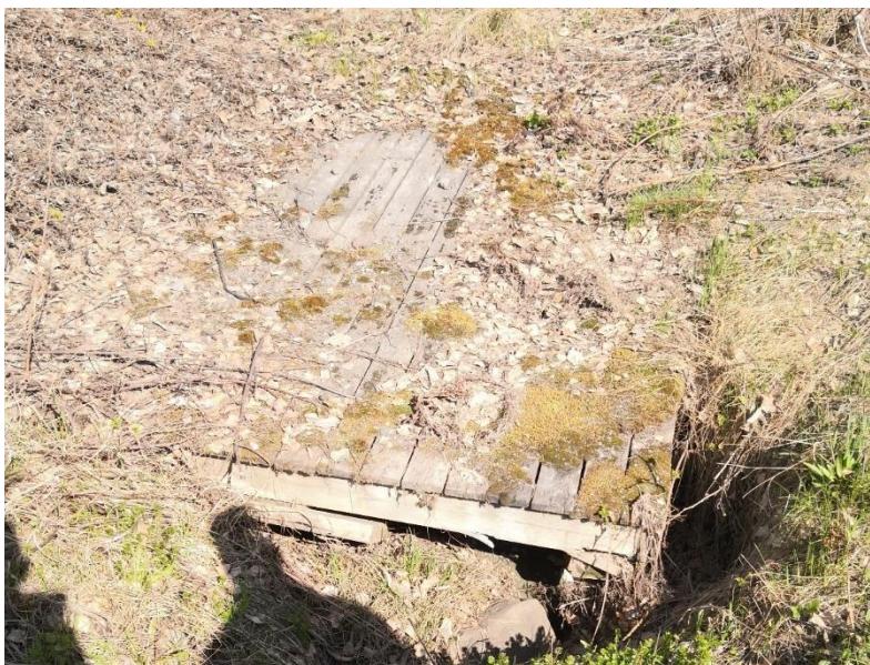
Figur 3-12: Trelokk over steinsatt sving på kulvert. Kan råtne og bli ustabil over tid.
