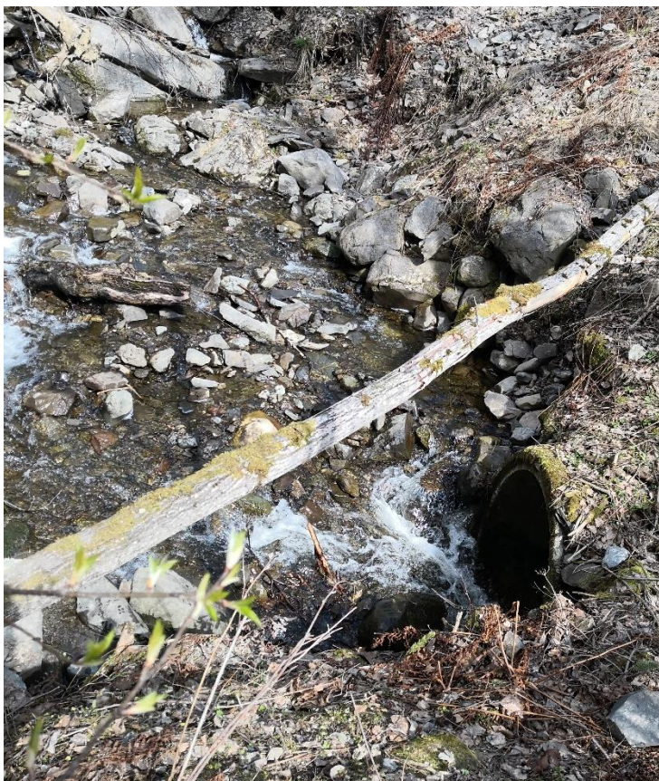
Figur 3-4: Innløp av stikkrenne under Hovslivegen. Røret ligger utsatt til for tilstopping.
