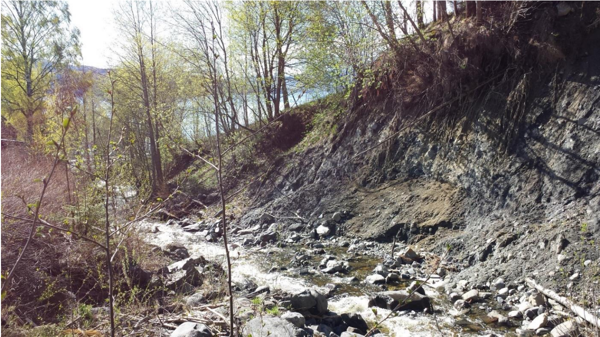
Figur 3-36: Erosjonsskader langs Øyresbekken i et relativt bratt parti. Mindre trær er i fare for å velte ut i bekken.
