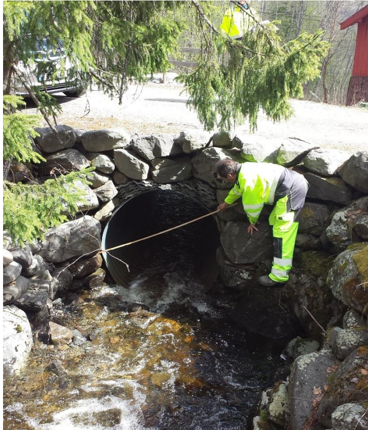
Figur 3-27: Innløp på kulvert under traktorvegn til Sagstuen. \varnothing 1400mm korrugert stålrør
