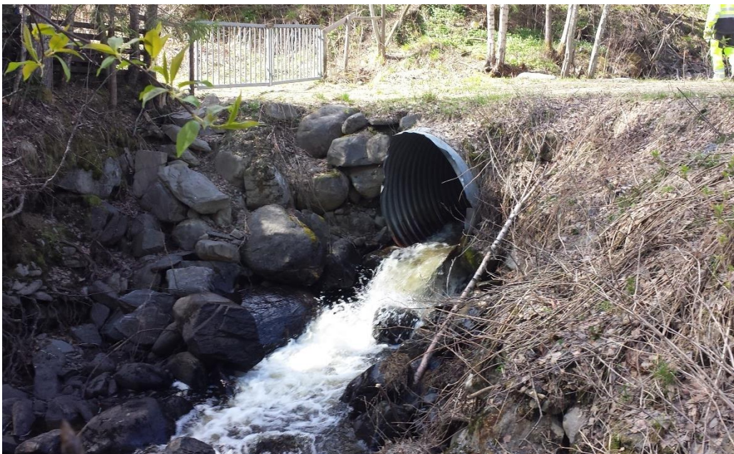
Figur 3-31: Utløp av kulvert av korrugert stålør under innkjøring til lagringsplass ved Øyrevegen 5
