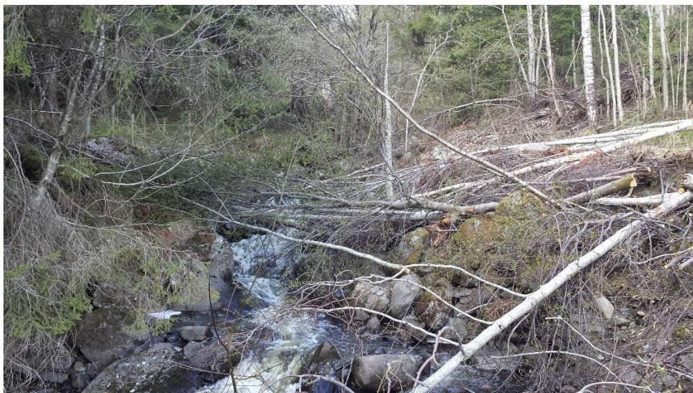
Figur 3-29: Mye nedfall i bekkeløp bidrar til å begrense kapasitet og gir risiko for tilstopping i kulverter.
