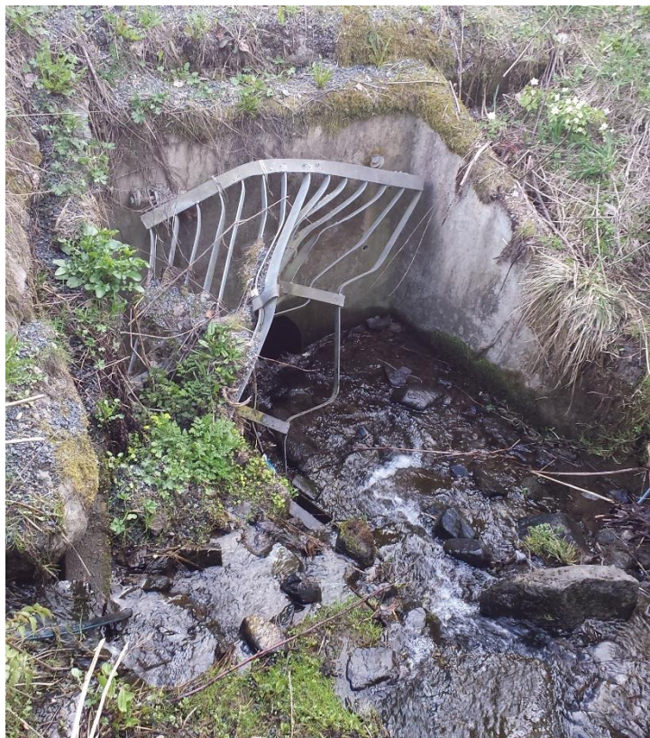
Figur 3-45: Innløp nedre lukking gjennom Saksumdalsvegen ved Ramberg. Ødelagt inntaksrist kan gi problemer med tilstopping.
