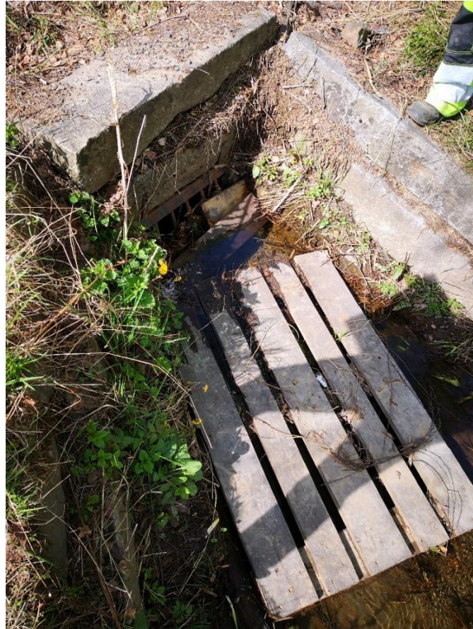
Figur 3-55: Innløp på lukking under Vingar Skole/Barnehage. Rist er tildekket av mye gjørme, samt større objekter som gir dårlige hydrauliske forhold ved innløpet.
