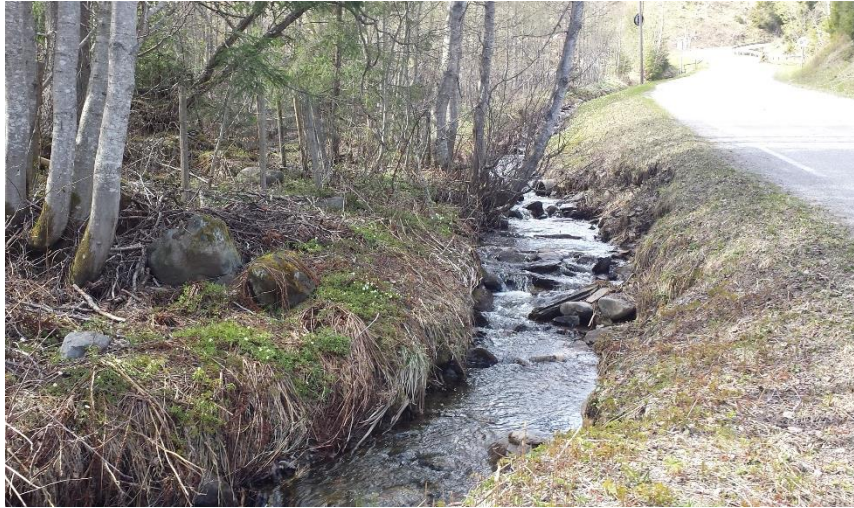
Figur 3-17: Nærføring av bekk til Saksumdalsvegen nedstrøms kryssing i stikkrenne, sett oppstrøms fra bekketryss ved Saksumdalsvegen 333. Det er tegn på erosjon mot vegen som trolig vil forverres ved hver flomhendelse.
