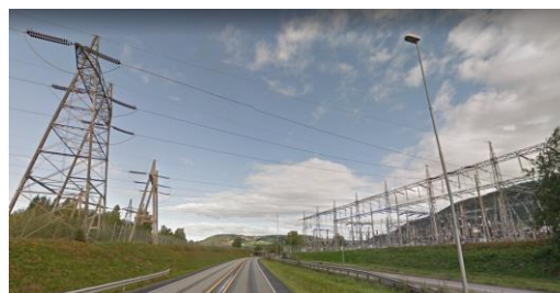
Figur 31 Statnetts trafostasjon på Hovemoen
