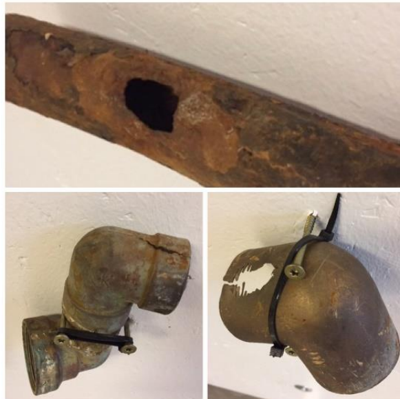
Deler av private vannledninger som ble byttet ut etter lekkasje. Foto: Knut Andreas Myklebust-Vårvang
