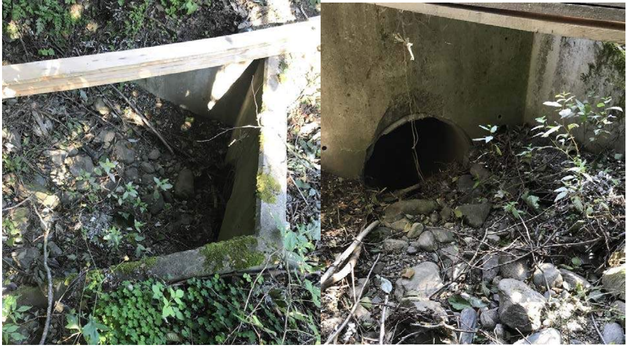
Stikkrenne under adkomstveg til Jørstadmivegen 192/194
