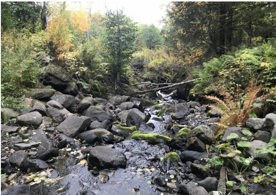
Figur 29 Ø12. Det er observert blokk og stein i bekken.
