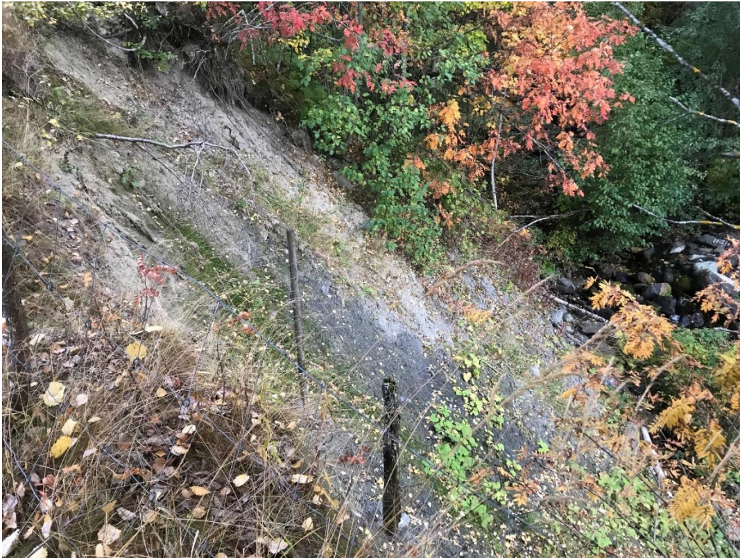
Figur 18 Ø2. Ca. 10 m høy erosjonsskråning tilsynelatende bestående av sand og noe stein. Erosjonsskråningen ligger på sørsiden av bekken. I bekken er det observert blokk og stein.
