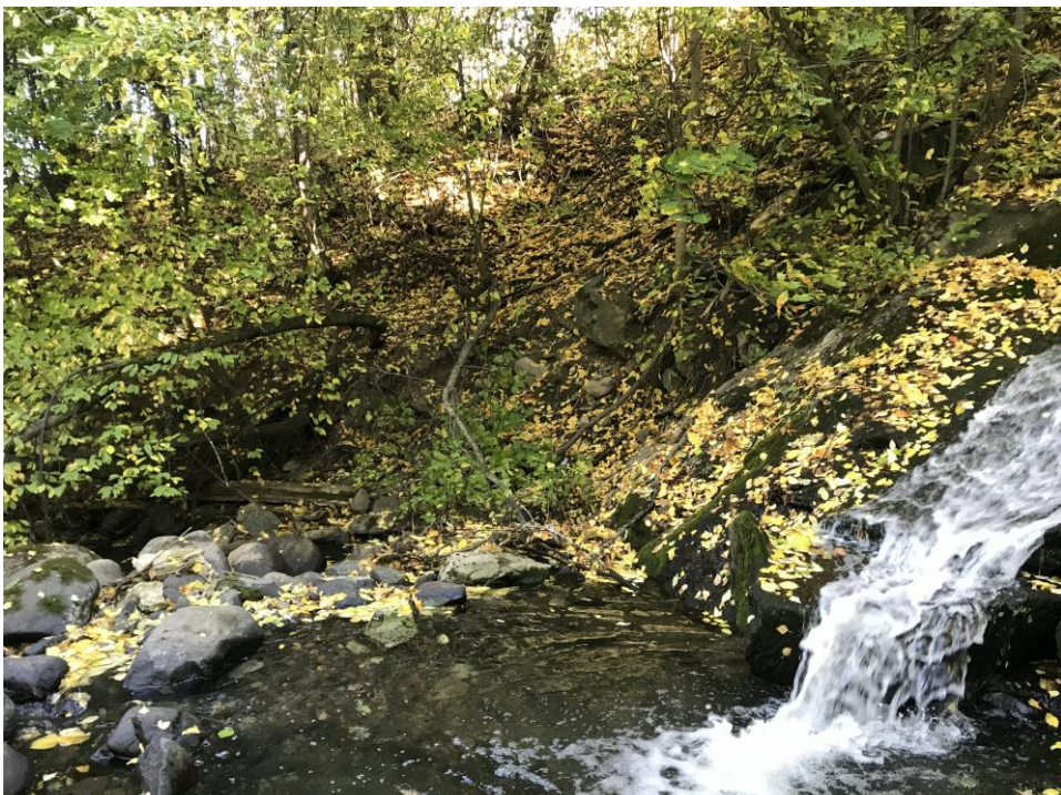
Figur 36 M2. Undergraving i sideterrenget nord for utløpet av kulverten under Lågenvegen. Løsmassene i sideterrenget består tilsynelatende av morenemateriale. Det er observert blokk og stein i bekken, samt berg i dagen ved utløpet fra kulverten (til høyre i bildet).
