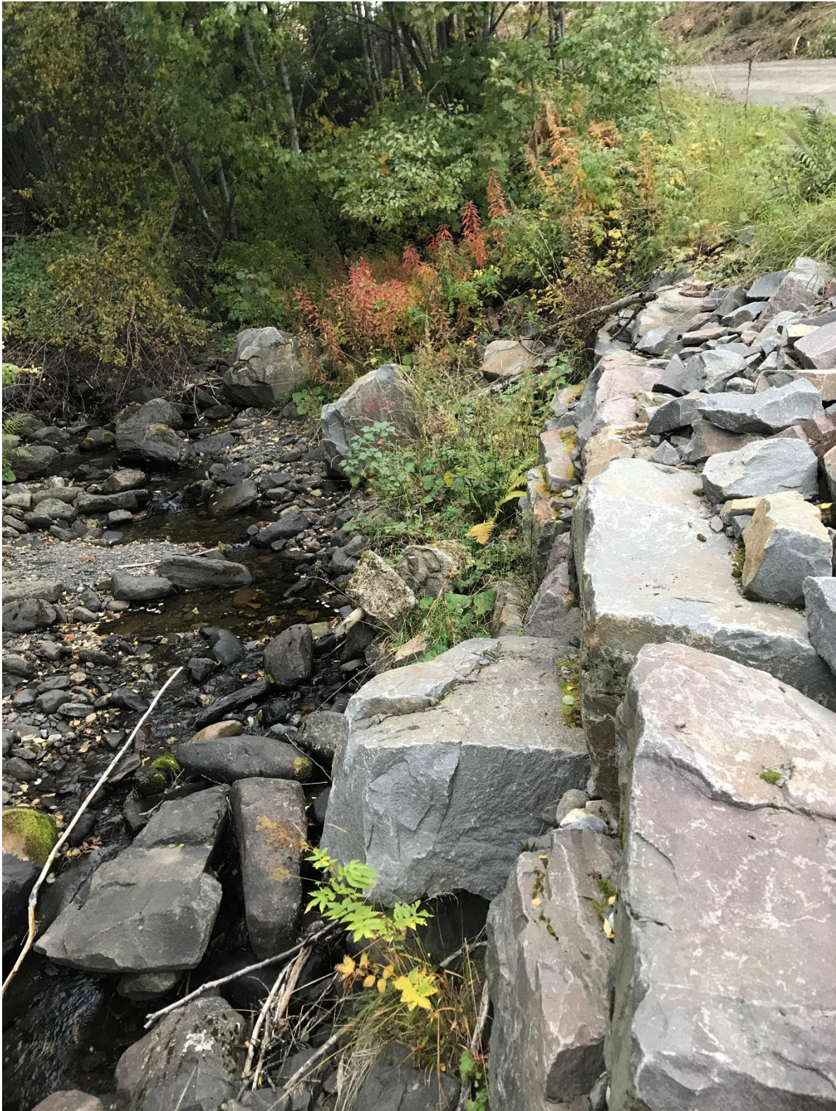
Figur 22 Ø6. Det er observert blokk og stein i bekken. Det eksisterer en mur mot den tilgrensede Øyrevegen.
