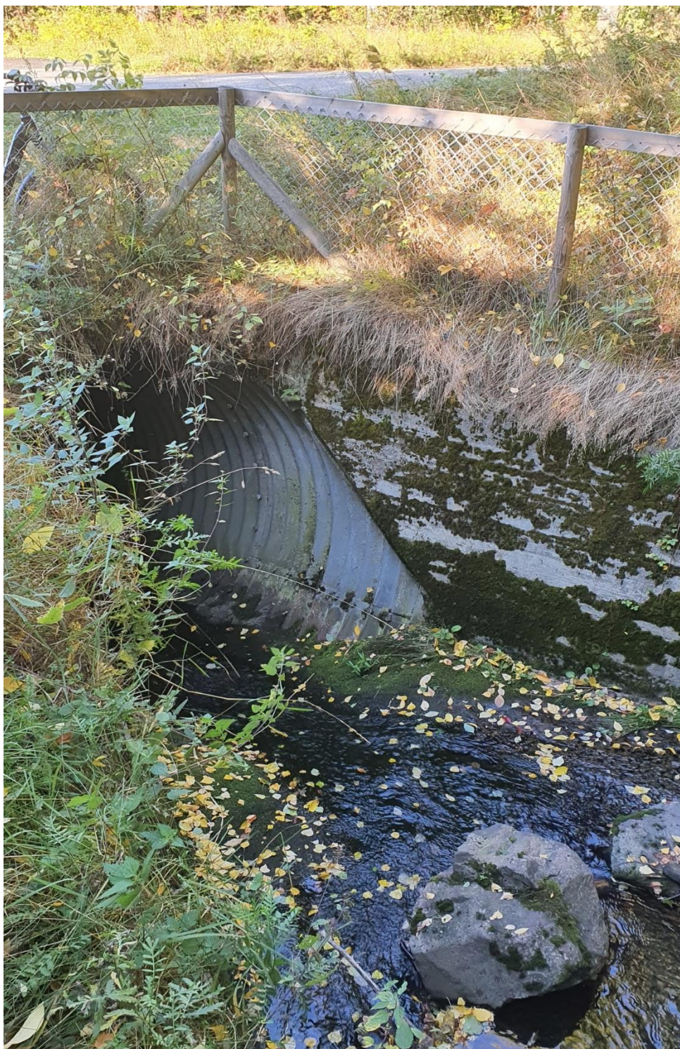
Figur 34 M1. Området utgjør ifølge aktsomhetskartet til NVE [8] et av løseområdene for jord- og flomskred. Bildet er tatt nedstrøms mot Lågenvegen.
