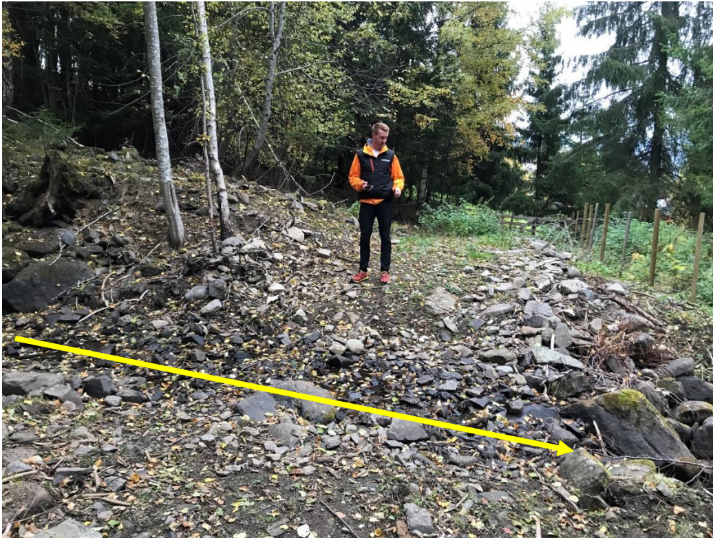
Figur 26 Ø9. Traktorvei på fylling krysser bekken uten etablering av kulvert eller lignende. Det er lite tegn til erosjon av fyllingen. Bekkens retning er indikert med gul pil.
